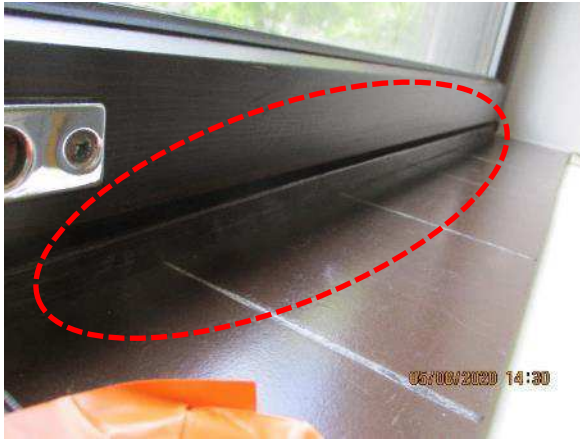
Kuva 205. MAK5: Laaja-alainen ilmavuoto havaittiin ikkunan ja ulkoseinän liittymässä.
