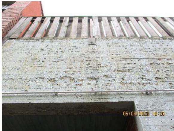
Kuva 86. Rakennuksen takana julkisivumaali hilseillee betonipinnalta.
