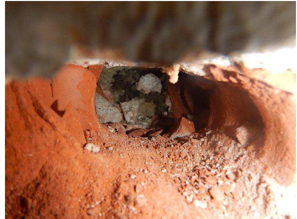
Kuva 106. Mineraalivillaeristeen seassa havaittiin valkoista ureaformaldehydivaahtoeristettä. Eristeen ja sokkelin välissä ei havaittu ilmatilaa.
