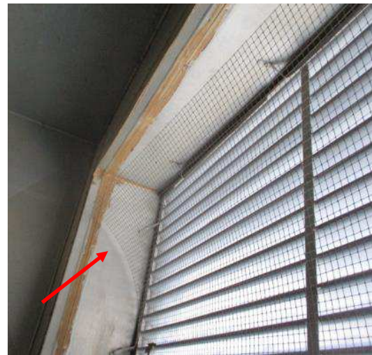
Kuva 408. TK01 (TK02) raitisilmasäleikön pieneläinverkko on paikoin irti
