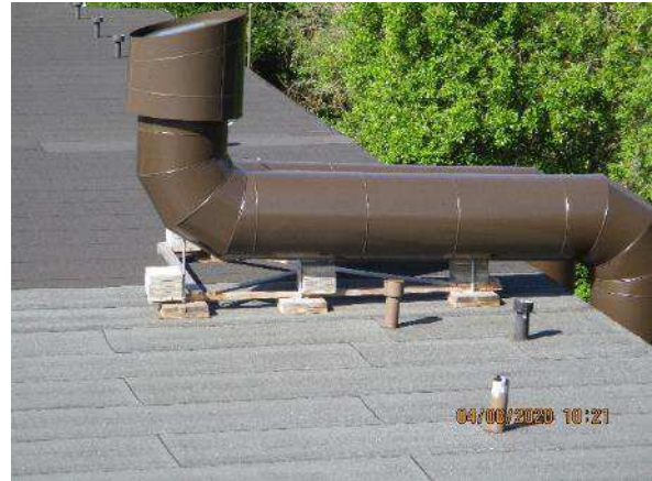
Kuva 317. Vesikatolla olevan huippumurin tuennat eivät ole asianmukaisia. Huippumuri on tuettu paikoilleen mm. betonilaatoin.
