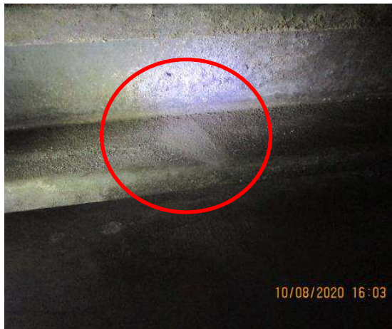
Kuva 440. TK05, puhallinkammiossa pölyä/likaa (pyyhkäisyjälki kuvassa)
