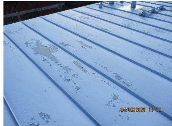
Kuva 331. Vesikatteen maalipinta on paikoin hilseillyt irti.
