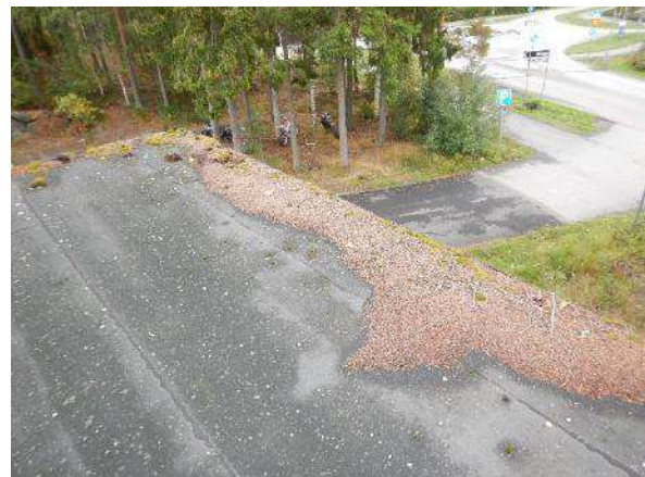
Kuva 345. Pajarakennuksen vesikatolla havaittiin sammalkasvustoa. Lisäksi neulaset ja muut roskat kasaantuvat vesikatteen reunoille aiheuttaen kosteuskuormitusta.
