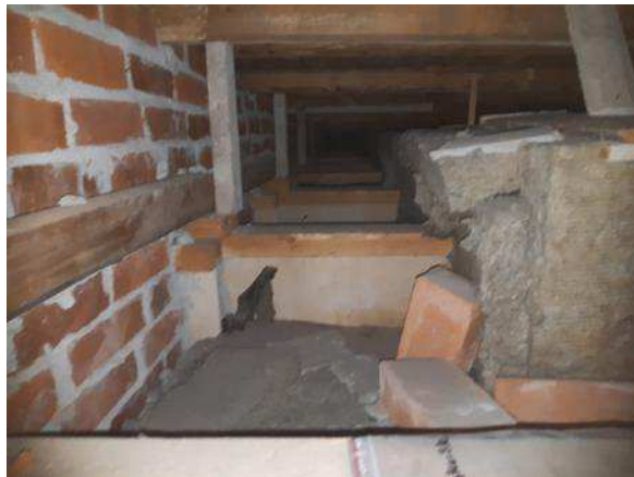
Kuva 312. Yläpohjatilassa havaittiin vesikatteelle asti nouseva tiilimuuraus.
