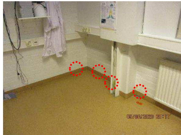
Kuva 60. MAK13 5.Fysiikka/Kemia luokassa: Ilmavuotokohtia havaittiin alapohjan ja seinien liittymäkohdissa sekä vesiputkien läpiviennissä.
