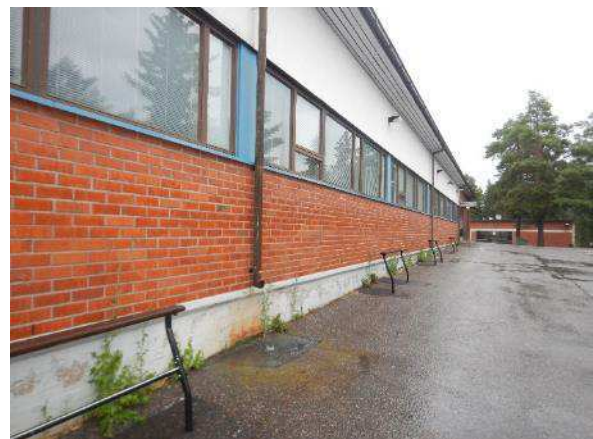
Kuva 388. Yleiskuva etupihan puolelta. Piha-alue on asfaltoitu ja maanpinta kallistaa rakennuksesta pois päin. Sokkelin vierustalla on kasvillisuutta joka lisää sokkelirakenteen kosteusrasitusta.
