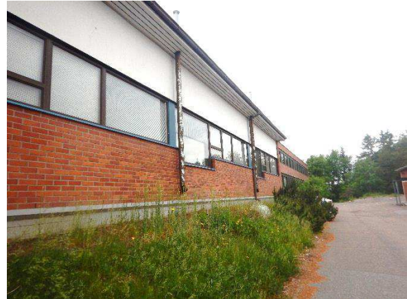
Kuva 390. Yleiskuva rakennuksen takapihan puolelta. Maanpinta kallistaa voimakkaasti rakennuksesta pois-päin, mutta sokkelin vierustalla kasvaa runsaasti kasvillisuutta.
