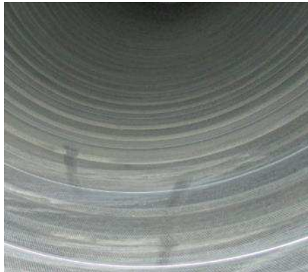
Kuva 457. TK01 palvelualue, ruokalan tuloilmakanava. Kanavassa vähäistä pölykertymää, pyyhkäisyjäljet kuvassa.
