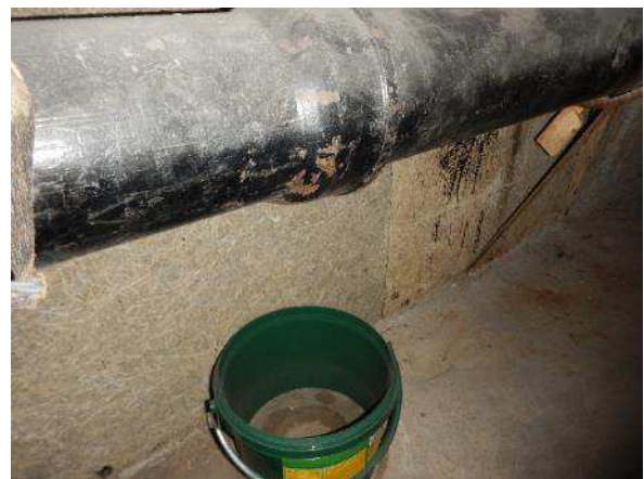
Kuva 297. Osan putkien alla ole ämpäri, mikä viittaa mahdollisiin viemärivuotoihin.
