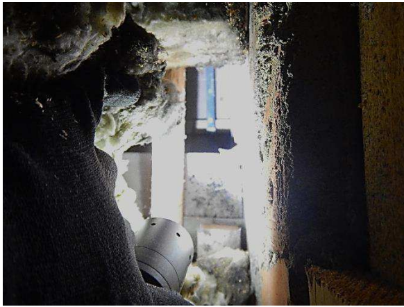
Kuva 366. Paikoin rakennuksen keskiosalla höyrynsulku puuttui kokonaan ja yläpohjasta näkyi sisäkaton alaslaskujen kipsilevy.
