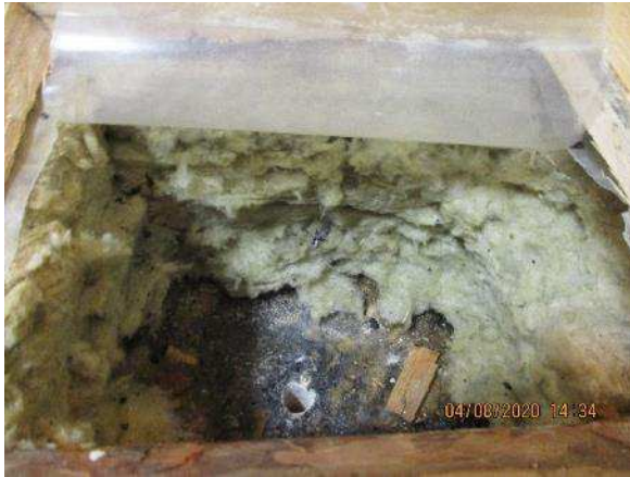
Kuva 46. Rakenneavaus AP 16. Rakenteessa on äänen- ja lämmöneristeenä mineraalivilla, josta otetussa mineraalivillaeristeestä havaittiin eriasteisia viitteitä vauriosta.
