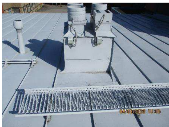
Kuva 332. Vesikatteen läpivientien yhteydestä puuttuvat harjataitteet, jotka ohjaisivat sadevedet pois läpiviennin alueelta.
