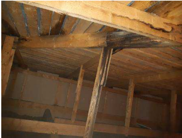
Kuva 371. Yläpohjatilassa on havaittavissa kattovuodosta aiheutuneen kosteuden aiheuttamia vaurioita.
