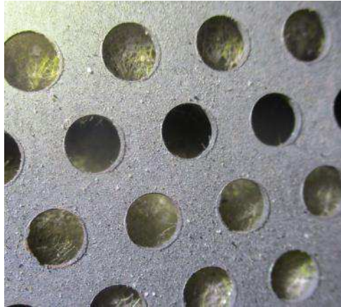
Kuva 459. TK03 palvelualue, tuloilmakanava iv-konehuoneessa. Kanavassa reikälevyn takana suojaamatonta mineraalivillaa.
