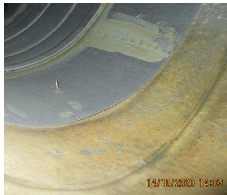
Kuva 462. TK03 palvelualue, tuloilmakanava käytävällä 1065, pyyhkäisynäytteen PK4 otto paikka, asbestia ei havaittu. Kanavaan jälkikäteen lisätyn säätöpellin alue erottuu alkuperäisestä pinnityneestä kanavasta selvästi.
