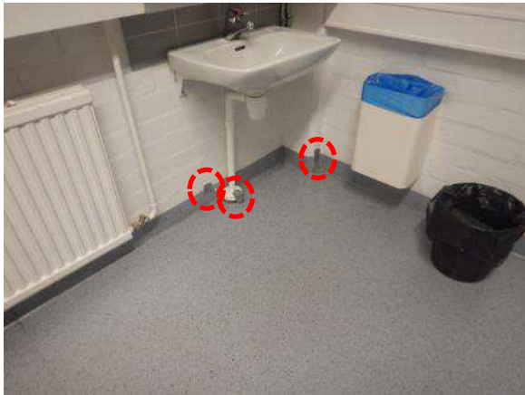
Kuva 302. 14. Uskonto, MAK14: Ilmavuotokohtia havaittiin muovimaton ylösnoston alueella, Viemäriiläpiviennissä sekä pilarin liitoskohdassa.
