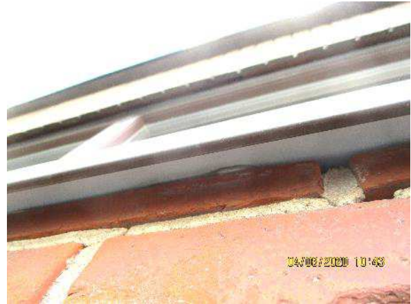
Kuva 181. Ikkunapellitys on asennettu tiiviisti alapinnalle, joka heikentää rakenteen tuulettumista.
