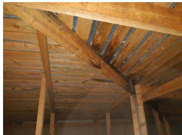
Kuva 339. Vesikatteen puuosissa havittiin paikallisesti kattovuodosta aiheutuneita vaurioita.
