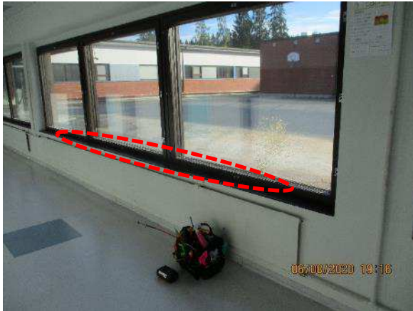
Kuva 217. Käytävällä 1030 havaittiin epätiivis ikkunan ja ulkoseinän liitos.
