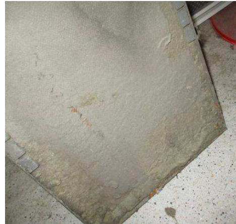
Kuva 433. TK04 suodatinkammion tarkastusluukun pinnassa suojaamatonta mineraalivillaa
