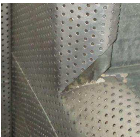
Kuva 436. TK04 tuloilmakammiossa on suojaamatonta mineraalivillaa
