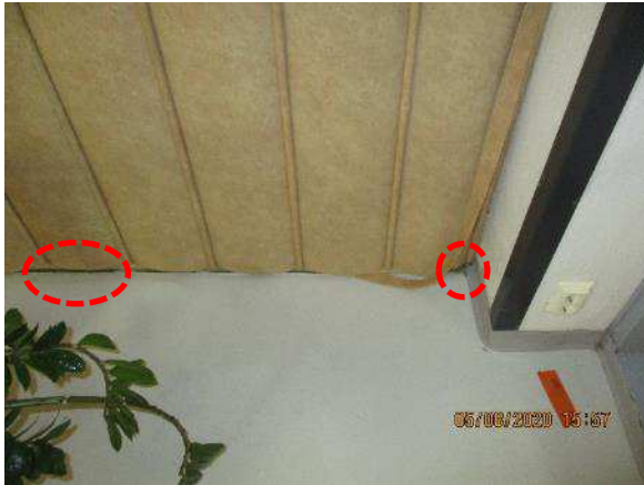
Kuva 242. MAK7: Ilmavuotoja havaittiin ruokalan välipohjarakenteen ja liikuntasalin välipohjarakenteen liitoksessa.
