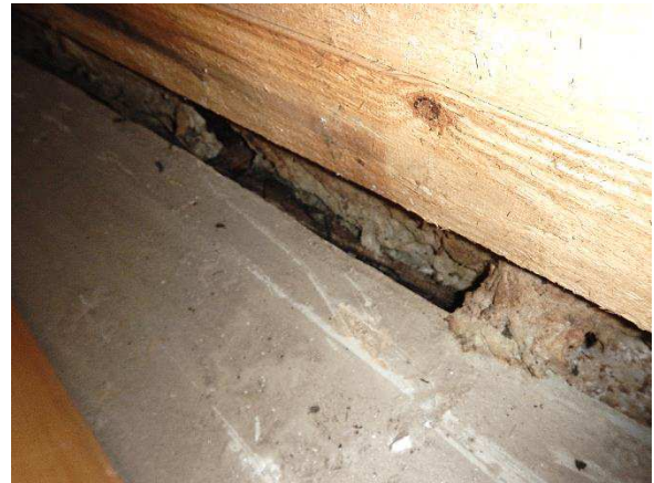
Kuva 254. Kellarikerroksen varastossa väliseinä oli päällystetty laudoituksella, joka oli alareunastaan lahonnut.
