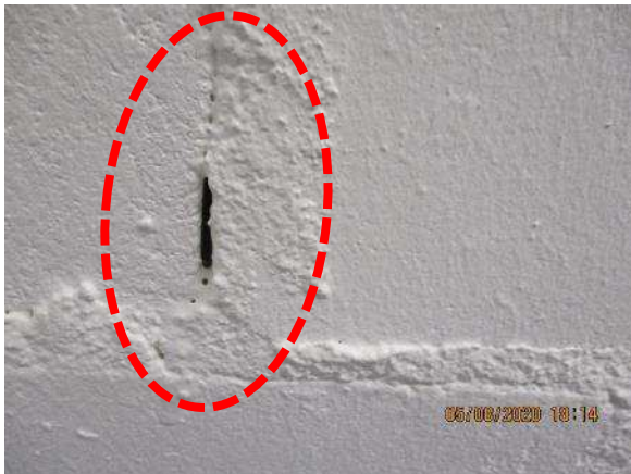
Kuva 75. MAK2: Ilmavuotoa havaittiin tiilimuurauksen saumakohdissa.
