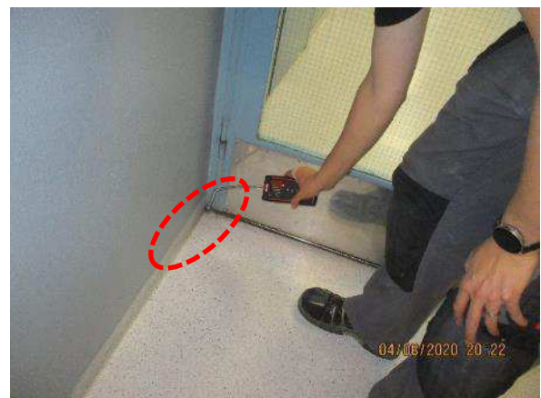
Kuva 247. MAK9: Ilmavuotoja havaittiin käytävän seinän ja välipohjan liitoksessa.
