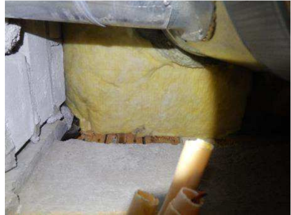
Kuva 379. Yläpohjasta havaittiin merkkiainekokeiden valmistelun aikana erittäin voimakas ilmavirtaus. Kuvassa näkyvässä puurakenteessa on kosteuden aiheuttamia värimuutoksia.
