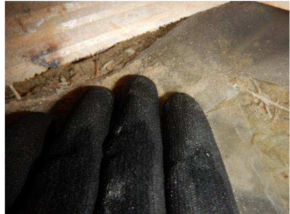
Kuva 47. Muovikalvo on asennettu rakenteeseen epätiivisti.
