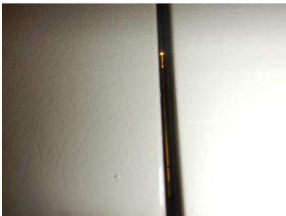
Kuva 285. Kaapistot ovat epätiivitä huoneiden välillä.
