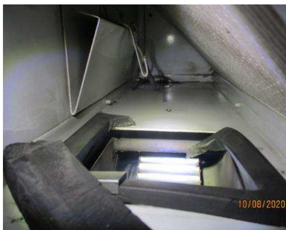
Kuva 447. Tulopuhaltimen kuminen kaulus rikki, ilma vuotaa puhaltimen painepuolelta imupuolelle
