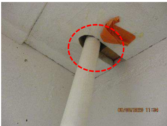
Kuva 213. MAK17: Lämpöputkikoteloinnista havaittiin vähäistä ilmavuotoa läpiviennin alueella.
