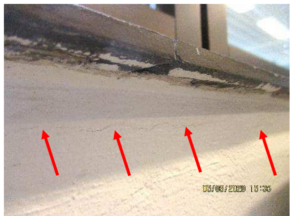
Kuva 198. MAK3: Ulkoseinällä olevassa halkeamassa havaittiin ilmavuotoa. Lisäksi ulkoseinän ja ikkunan liitoksessa havaittiin ilmavuotoa laaja-alaisesti.
