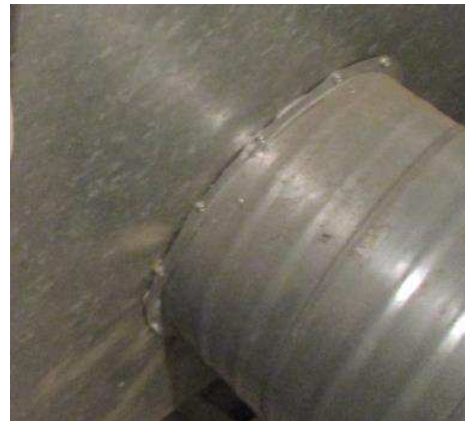
Kuva 468. TK04 palvelualue, kanavaliitos tuloilmakammioon iv-konehuoneessa epätiivis, liitoksessa vuotojäljet.
