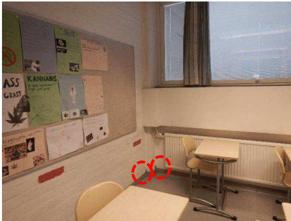
Kuva 304. 11.Äidinkieli MAK15: Merkkiainekokeessa havaittiin ilmavuotoja pilarin liitoksissa.
