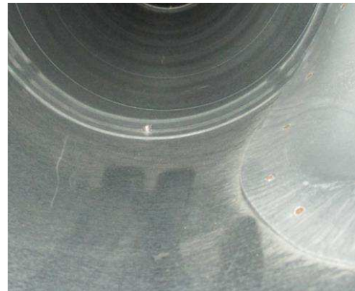
Kuva 480. Pajarakennus, luokkatila T28, tuloilmakanavassa lievää pölykertymä, pyyhkäisy jäljet kuvassa
