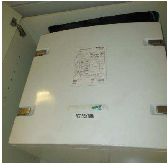
Kuva 443. Kansliatilojen ilmanvaihtokone TK07
