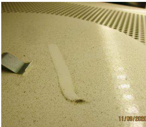
Kuva 488. TK05 palvelualue, luokka 27, TKB-mallisen tuloilmapäätelaitteen levyssä pölykertymää
