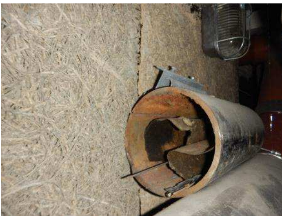
Kuva 296. Putkikanaalissa havaittiin muutamia käytöstä poistettuja putkia.
