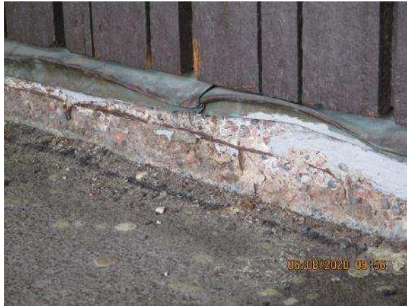
Kuva 84. Matalamman käytävä- ja luokkaosan sokkelirakenteen raudoitukset ovat näkyvillä. Suojapellitykset alueella ovat huonokuntoisia.
