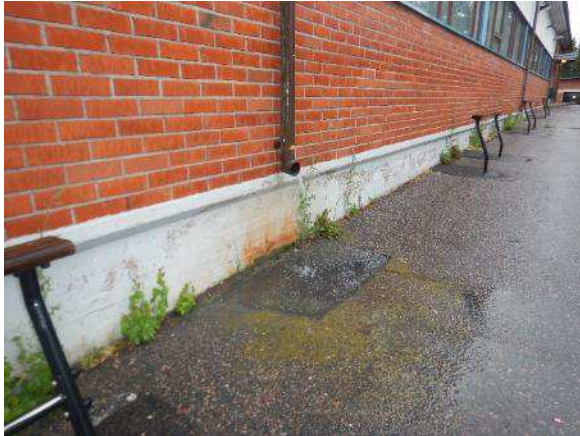
Kuva 389. Syöksytorvet ohjaavat sadevedet suoraan sokkeliä vasten, mikä aiheuttaa voimakasta kosteuskuormitusta ulkoseinä- ja sokkelirakenteille..
