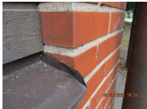
Kuva 99. Ikkunapellityksien epätiiveytskohtien kautta ulkoseinärakenteeseen voi päätyä sadevesiä esimerkiksi kovan tuulen vaikutuksesta.
