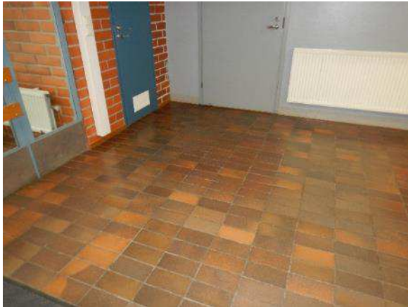
Kuva 221. Yleiskuva vanhan osan aulasta. Lattiapäällysteenä on keraaminen laatta. Aulatilain lattiassa havaittiin voimakkaita lattipinnan kohoumia ja painaumuksia
