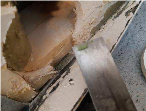
Kuva 265. Alapohjaa vasten olevan väliseinän koo- lauspuun alla havaittiin vihertävä eristeikaista.
