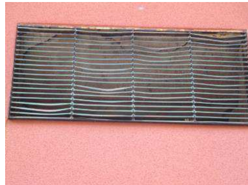
Kuva 429. TK04 raitisilmäsäleikkö on alkuperäinen. Säleet ovat paikoin vääntyneitä, säleikön lumen ja veden vastustus on huono eikä säleikössä ole pieneläinverkkoa.
