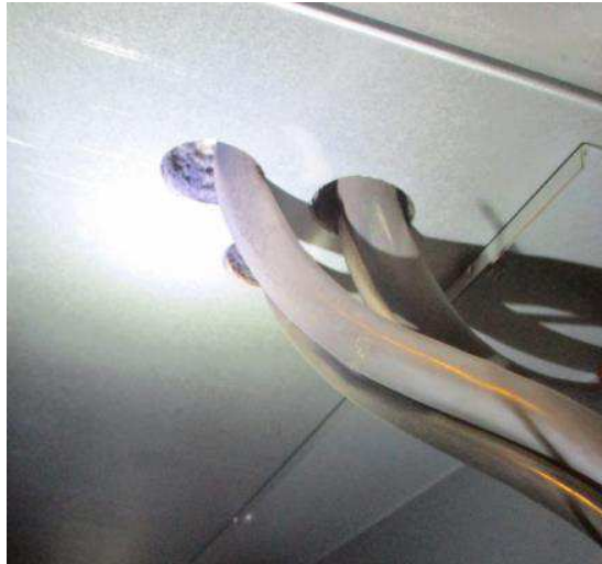
Kuva 425. TK03, epätiivis johtoläpimeno poistoilmapuolella LTO-kammiossa
