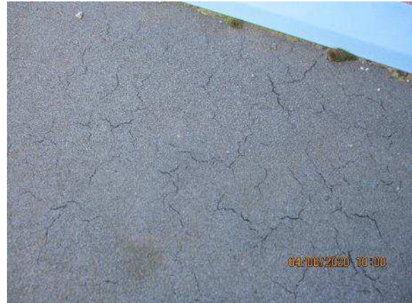
Kuva 335. Vesikatossa on havaittavissa halkeamia.
