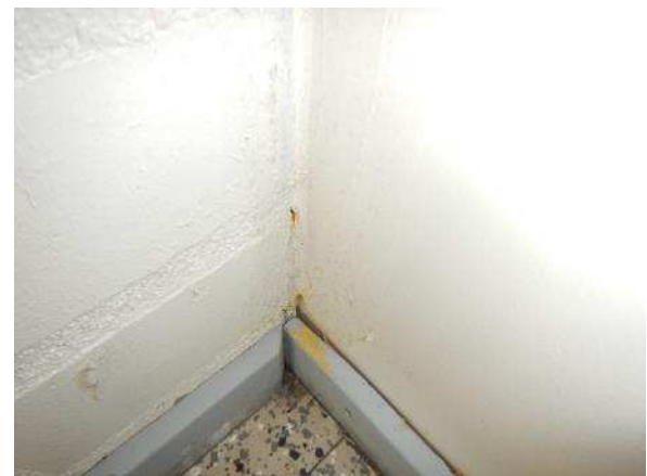
Kuva 286. Kaapiston ja lattian liittymä. Jalkalistan takana havaittavissa värimuutoksia.
