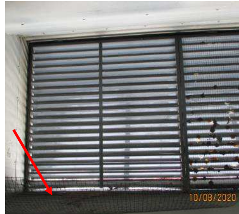
Kuva 420. TK03 raitisilmasäleikön toisen puoliskon peneläinverkko on irronnut
