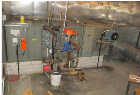
Kuva 428. Liikuntasalin ja pukuhuoneiden tuloilmakone TK04
