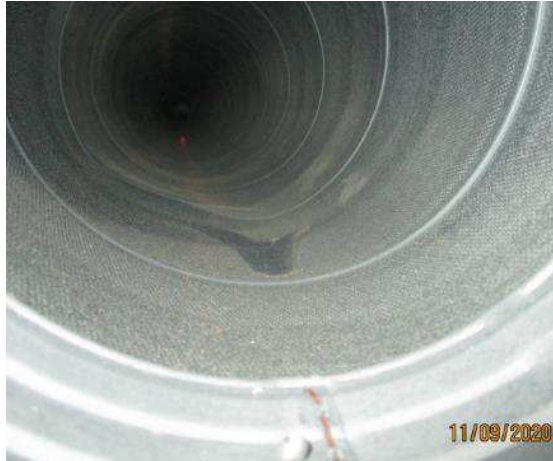
Kuva 477. TK07 palvelualue, kanslian tuloilmakanavassa pölykertymä. Pyyhkäisy jäljet kuvassa.
