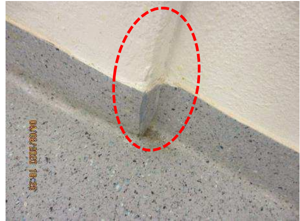
Kuva 194. MAK4: Patterisyvennyksen ja pilarin liitoksessa havaittiin pistemäisiä ja vähäisiä ilmavuotokohtia.
