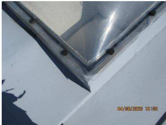
Kuva 330. Kattoikkunoiden muoviosat ovat paikoin halkeilleet
