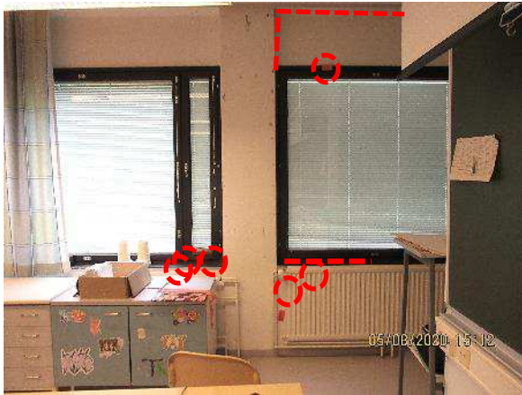
Kuva 207. 24. Kuvaamataito, MAK6: Havaitut ilmavuotokohtat merkittynä kuvaan. Ilmavuotoa havaittiin muiden ulkoseinille tehtyjen merkkiainekokeiden tapaan ikkunaliitoksissa, patterikiinnikkeiden alueella sekä ulkoseinän, patterisyvennyksien ja välipohjien alueelle.
