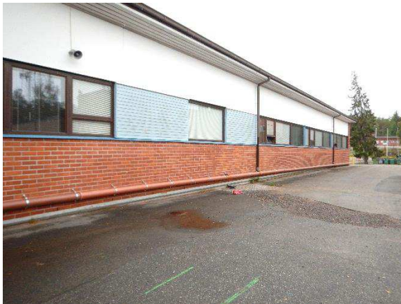
Kuva 383. Sisäpihan vedenhallintaa on osin parannettu asentamalla laajennusosan seinustalle erillinen putki, joka johtaa sadevedet pois piha-alueelta.
