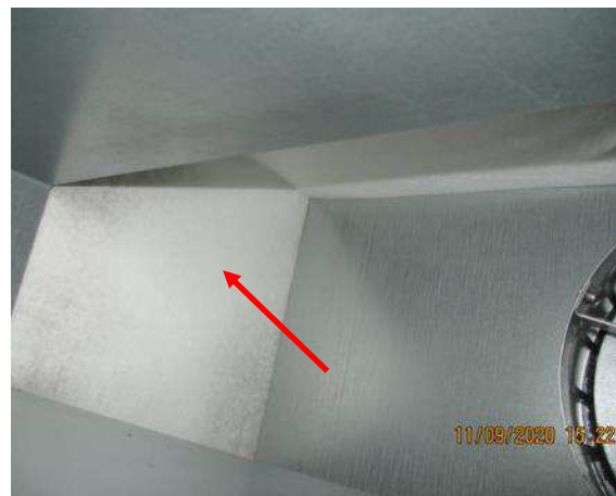
Kuva 495. Pajarakennus, tuloilmapäätelaitteiden vaimenusmateriaali on polyesteripohjaista (ei mineraalivillaa)
