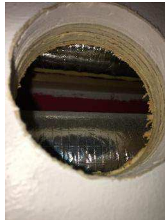
Kuva 272. Putkien mineraalivillaeriste oli pinnoitettu.
