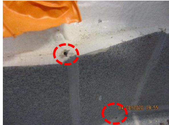
Kuva 58. Laatoituksen ylösnostossa sekä silikonisaumoissa on havaittavissa epätiiveytskohtia.
