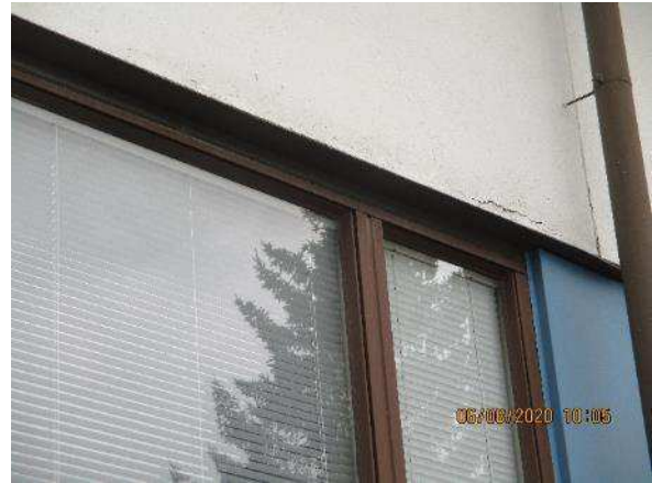
Kuva 91. Ikkunoiden yläpuolella on paikoin havaittavissa halkeamia julkisivulevytyksessä.
