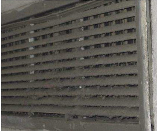
Kuva 485. Liikuntasalin poistoilmasäleiköt olivat huomattavan pölyntyneitä.
