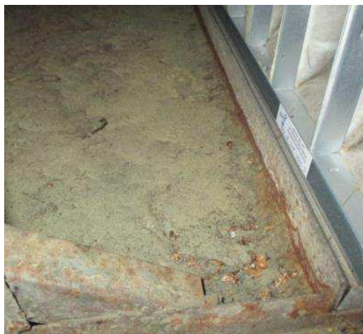
Kuva 430. TK04, raitisilmakammio on erittäin likainen, kammiossa on kosteuden aiheuttamia korroosiojälkiä
