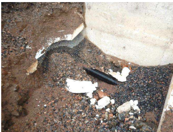
Kuva 385. Keittiön laajennuksen yhteyteen on asennettu salaojat.
