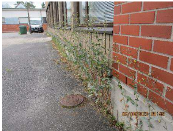
Kuva 82. Ruokalan sokkelinvierustalla kasvaa rikkakasvillisuutta, joka lisää sokkelirakenteen kosteusrasitusta.
