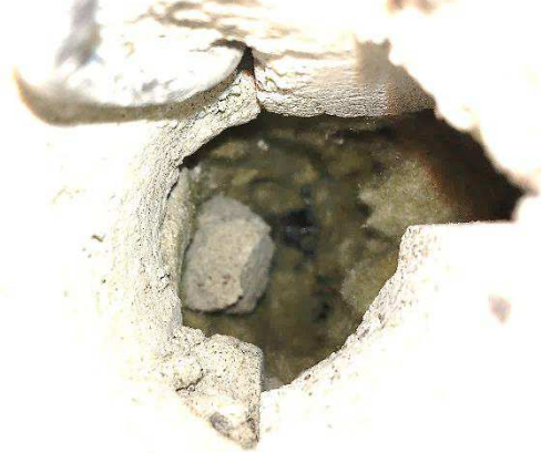
Kuva 72. Sisäkuorimuurauksen takana on lämmöneristeenä mineraalivilla, jossa havaittiin laboratorioanalyysissä heikko viite vauriosta.
