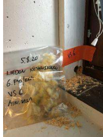
Kuva 270. Väliseinän ja ikkunan välinen liitos oli eristetty mineraalivillalla, joka jatkui toiseen luokkaan asti. Mineraalivillassa havaittiin tummentumaa.
