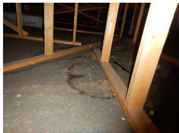
Kuva 357. Vanhan vesikatteen päällä havaittiin vanhoja vesivuotojälkiä.
