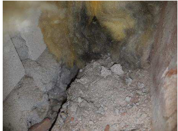
Kuva 154. US19: Eristeen ja muurauksen välissä ei havaittu tuuletusrakoa. Mineraalivillaeristeessä on havaittavissa ilmavirtausten aiheuttamaa tummentumaa.
