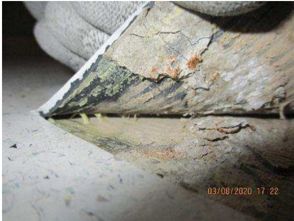
Kuva 50. Muovimaton liima on avauskohdassa venyvää. tasoihteessa on havaittavissa ruostetta, joka on peräisin vanhasta, mahdollisesti väliseinän, kiinnikkeestä.
