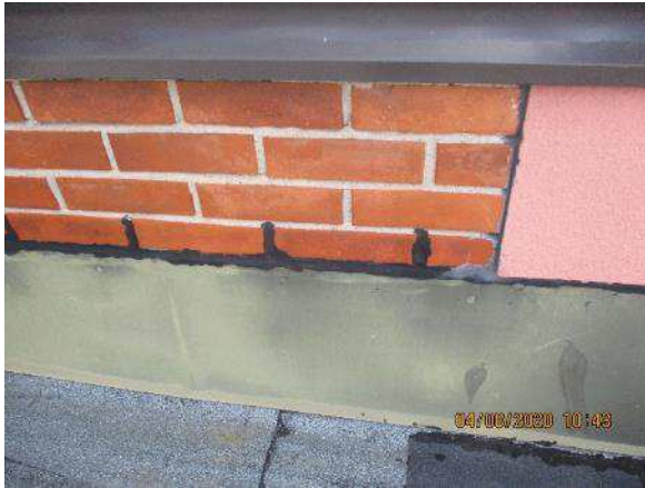
Kuva 180. Julkisivumuurauksessa ei ole tuulettumisen mahdollistavia avoimia pystysaumoja.
