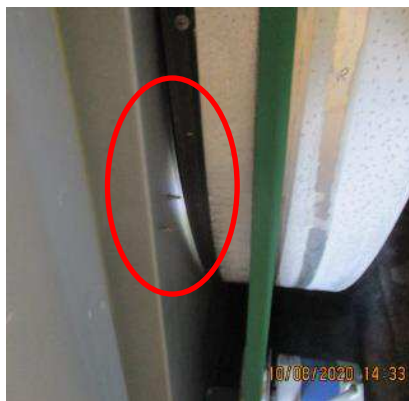
Kuva 421. TK03, LTO-kiekon reunan harjatiiviste on kulunut (toiselta puolelta osoitettu valo näkyy selvästi läpi)
