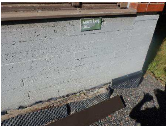
Kuva 391. Patolevyn peitelista on irronnut.
