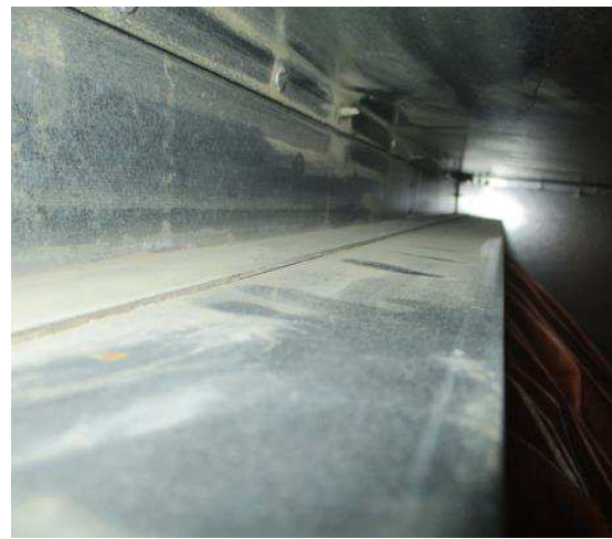
Kuva 456. Poistoilmasuodatinkammiossa on puupölyä
