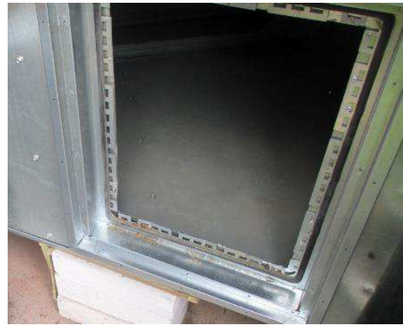
Kuva 450. Raitisilmakammiossa ei ole vedenpoistoa
