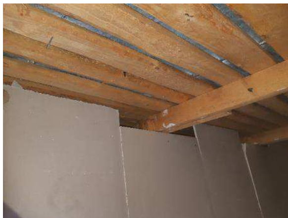
Kuva 338. Vesikatteen alla ei ole aluskatetta. Kipsilevytyksin toteutettu palokatko on epätiivis kattorakenteen kohdassa.
