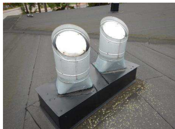
Kuva 351. Pajarakennuksen korotusosan vesikatolla havaittiin sammalkasvustoa läpivientien kohdalla.
