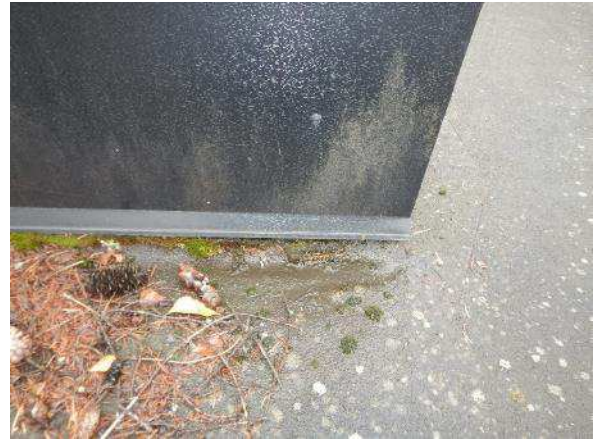
Kuva 347. Pajarakennuksen vesikatolla on läpivientejä, joista puuttuvat harjataitteet, jotka ohjaisivat sadevedet pois läpivientien alueelta.
