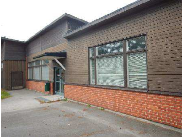
Kuva 395. Maanpinta kallistaa voimakkaasti Pajarakennuksen ulkoseinää kohti.
