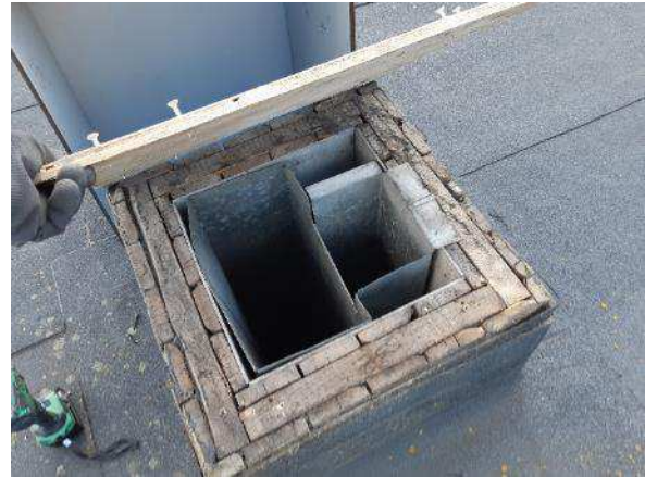
Kuva 323. Vesikatolla on käytöstä poistettu huippuimuri, joka on pellitetty umpeen.
