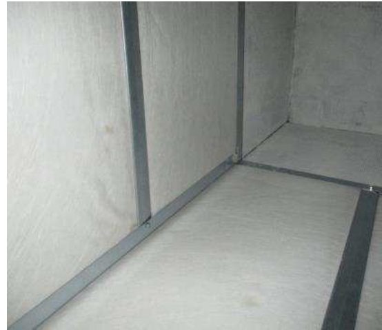
Kuva 454. Tuloilmakammion vaimennusmateriaaleja on uusittu polyesteripohjasella materiaalilla
