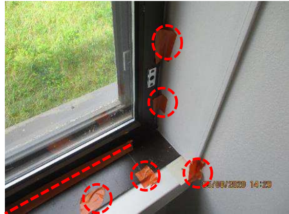
Kuva 206. MAK5: Pistemäisiä ilmavuotokohtia havaittiin ikkunapenkkinen, sähkökoteloitien sekä ikkunan ja ulkoseinän liittymässä.
