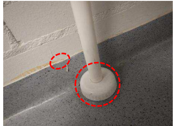
Kuva 303. MAK14: Ilmavuotoja havaittiin muovimaton ja seinien liitoskohdassa, muovilistan takana.
