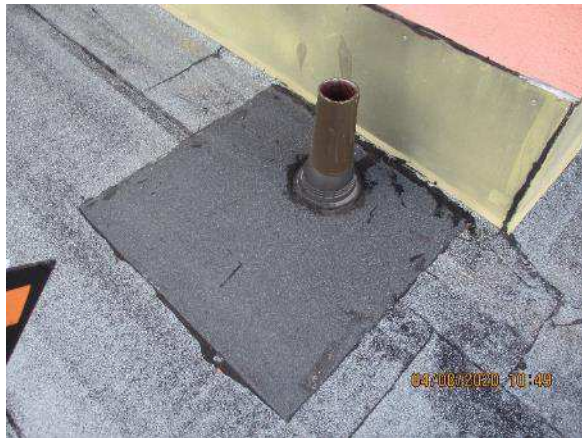
Kuva 318. Vesikatetta on korjattu paikkakorjauksin. Ylösnostopellityksiä on korjattu ajan saatossa massakorjauksin.
