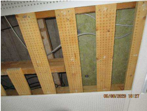
Kuva 403. Alkuperäisen osan käytävien alaslaskuissa oli reikälevyä, jonka päällä havaittiin yksittäisiä pinoittamattomia IV-kanavien eristeitä.
