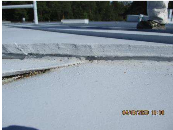
Kuva 328. Tehtyjen havaintojen perusteella konesaumapellitusten liitoksissa on ollut ajan saatossa epätiiveyttä.
