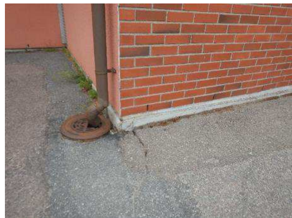
Kuva 386. Keittiön kohdalla sadevedet on johdettu erilliseen sadevesikaivoon.
