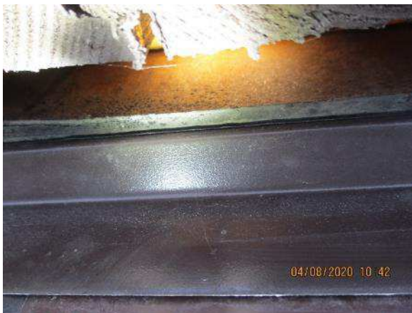
Kuva 182. Ikkunan yläpuolella ulkoseinärakenteesta puuttuu ristiinkoolaus, joka mahdollistaisi rakenteen riittävän tuulettumisen.
