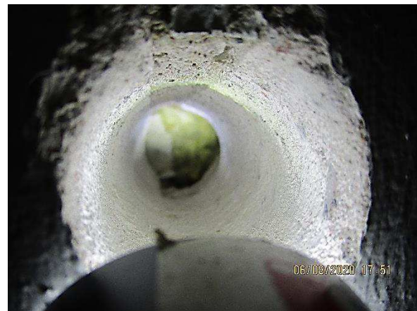
Kuva 186. Rakenneavauksesta US27 havaittiin mikrobiperäinen haju.
