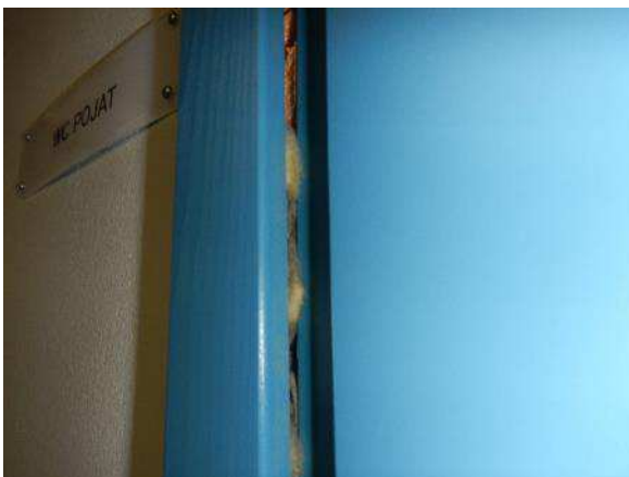
Kuva 401. Ikkuna- ja ovilistoituksissa havaittiin puutteita, jolloin mineraalivillaeristeet ovat yhteydessä sisäilmaan.
