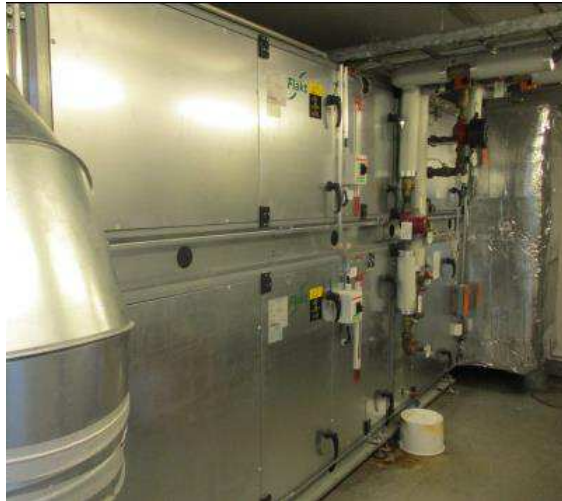
Kuva 413. Keittiön tuloilmakone TK02 kuvassa ylempänä (alla ruokalan tuloilmakone TK01)
