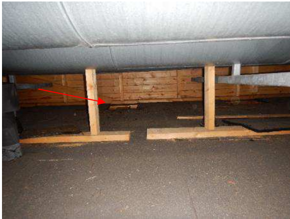
Kuva 360. Vanhaan vesikatteeseen oli sahattu tuuletusaukkoja räystääslinjoille ja rakennuksen keskelle.
