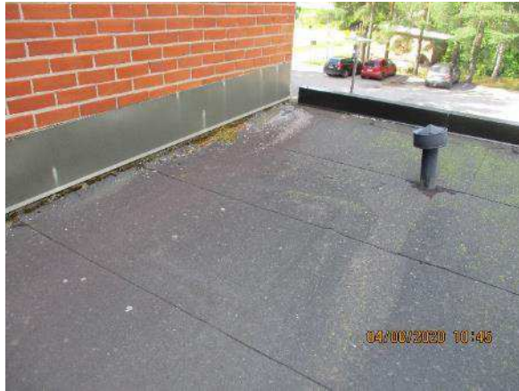
Kuva 310. Vesikatteen pinnalla havaittiin paikoin huopakatteen poimuttumista, joka viittaa katteen irtoamiseen alustastaan.
