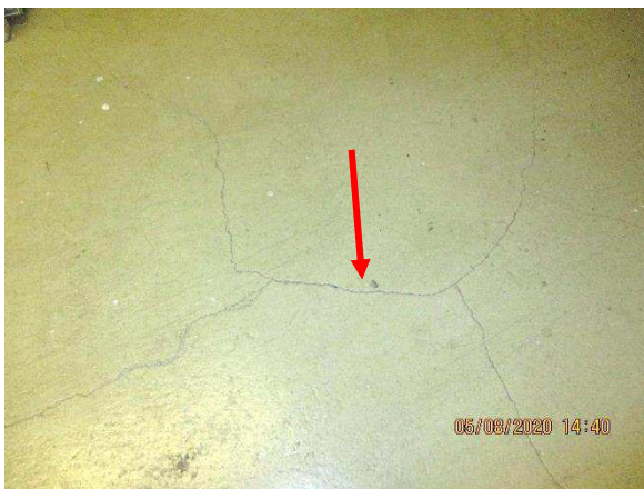
Kuva 65. Aistinvarainen havainto, kiinteistöhoitajan huone, 0-kr: Alapohjarakenteen pinnalla on havaittavissa halkeamia, jotka eivät todennäköisesti ole ilmatiiviitä.
