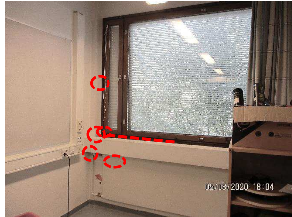
Kuva 208. Opo 1039, MAK11: Alueella havaitut ilmavuotokohtat merkittynä kuvaan. Ilmavuotoa havaittiin muiden merkkiainekokeiden tapaan ikkunan ja ulkoseinän liitoksessa ja patterikiinnikkeissä. Näiden lisäksi epätiiveyttä havaittiin lämpöputkikoteloinnista.
