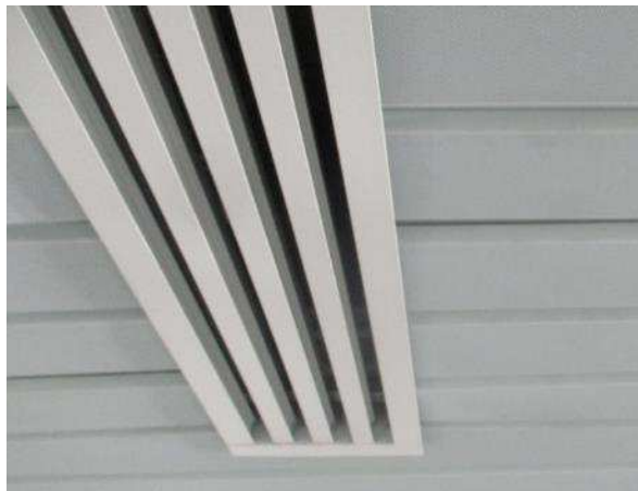
Kuva 497. Laajennusosa, luokka 9, tuloilmapäätelaitteen säleet suunnattu siten, että puhallus suoraan alaspäin,
