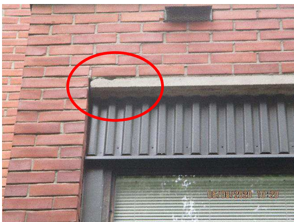
Kuva 100. Ikkunanylityspalkeissa on havaittavissa halkeamia.
