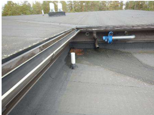
Kuva 342. Pajarakennuksen korotusosan sadevedet on johdettu suoraan alkuperäisen osan vesikatteelle.
