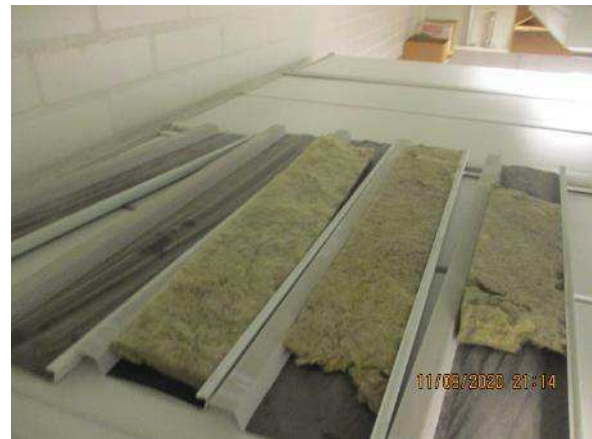
Kuva 406. Opettajahuoneen varaston katossa havaittiin peltipaneelikaton päällä mineraalivillaeristeitä.
