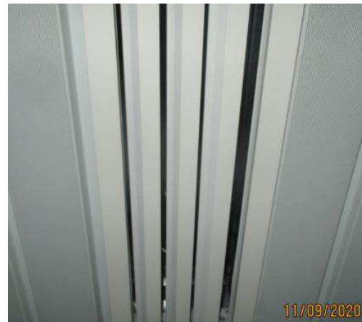
Kuva 498. Laajennusosa, luokka 12, tuloilmapäätelaitteen säleet suunnattu siten, että puhallus ikkunaseinälle päin
