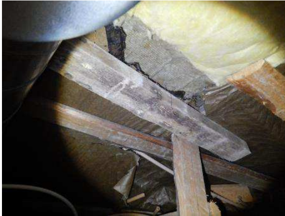
Kuva 378. Rakenneavaus YP6 tehtiin pajarakennuksen yläpohjarakenteeseen alakautta. Ilmansulun havaittiin puuttuvan paikoin rakenteesta.
