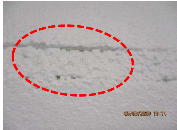
Kuva 76. MAK2: Ilmavuotoa havaittiin tiilimuurauksen saumakohdissa.
