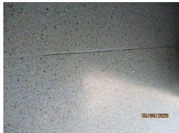
Kuva 14. Muovimattopäällysteiden saumoissa havaittiin paikoin halkeamia.
