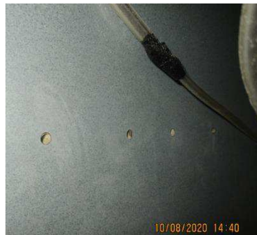
Kuva 424. Tulopuhallinkammion sisäpinnassa reikiä, joissa suojaamatonta mineraalivillaa
