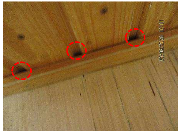
Kuva 245. MAK7: Ilmavuotoja havaittiin paneloinnin alaosassa paneloinnin liitoksissa. Ilmavuodot viittaavat välipohjaliitoksen epätiiveyteen.
