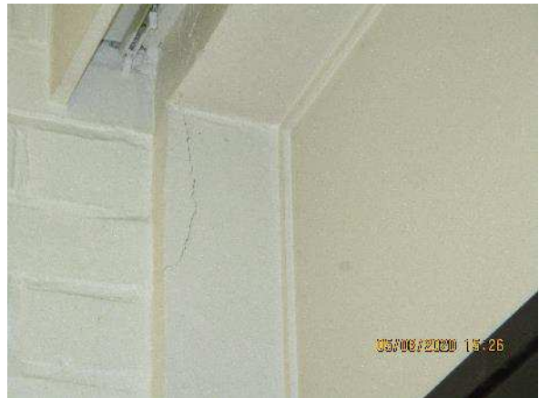
Kuva 196. MAK3: Ilmavuotokohta ulkoseinän yläosan halkeamassa.
