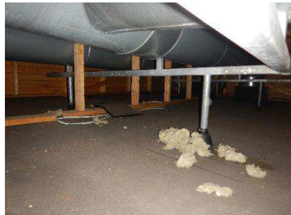
Kuva 355. Pajarakennuksen korotusosan yläpohjatilassa oli rakennusaikaista jätettä.
