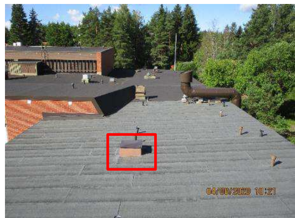
Kuva 315. Käytävän 1030 alueella olevaan yläpohjaan ei ollut pääsyä. Kuvaan merkitty läpivienti on käytöstä poistettu huippu-imuri. Vesikate alueella on käyttökänsä päässä. Alueen yläpohjatilaan ei ollut pääsyä.
