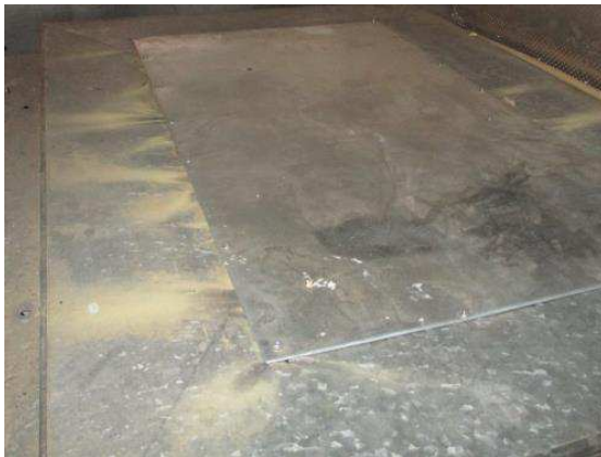
Kuva 467. TK04 palvelualue, tuloilmakammion puhdistusluukku iv-konehuoneessa on epätiivis, luukun reunoilla vuotojäljet
