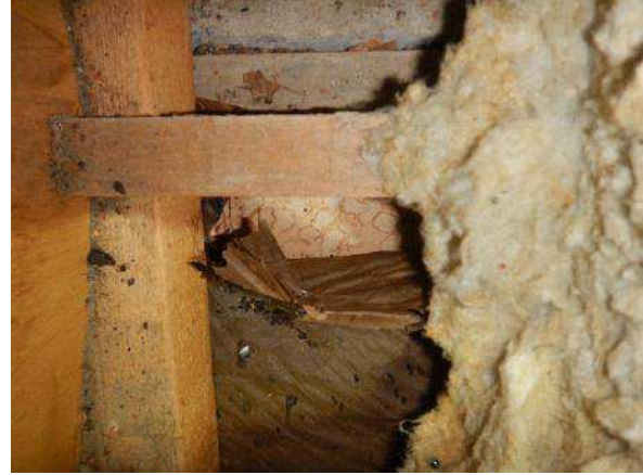
Kuva 365. Paikoin aukoista oli havaittavissa alkuperäinen ilmansulkupaperi.
