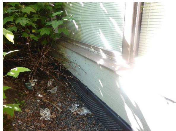
Kuva 392. Rakennuksen seinustalla kasvaa runsasta kasvillisuutta.
