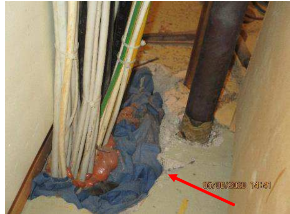
Kuva 64. Aistinvarainen havainto, kiinteistöhoitajan huone, 0-kr: Läpiviennit eivät ole tiiviitä.
