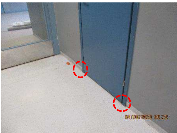
Kuva 246. MAK9: Kellarikerroksen ja 1.kerrosn käytävien välillä havaittiin ilmavuotoa WC:n oviaukon alueella.
