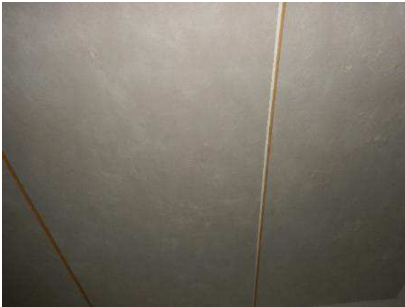
Kuva 399. Paikoin akustolevyjä havaittiin pinnoittamattomia reunoja.
