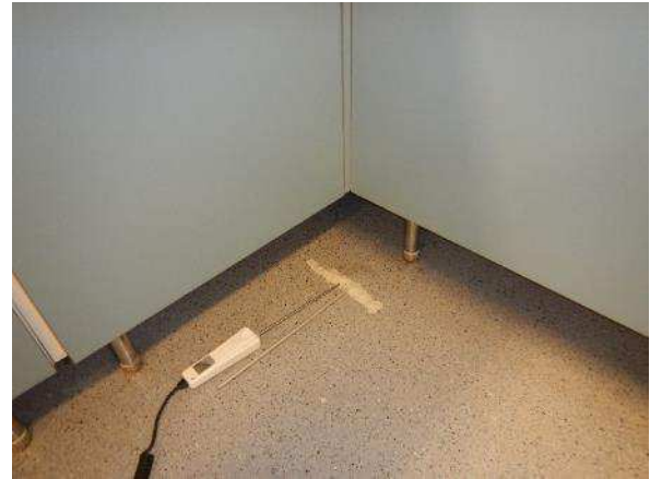
Kuva 56. VM3: 31 Kotitalous luokan kaapistojen alla havaittiin poikkeavia pintakosteuslukemia sekä rakeneavauksesta kosteutta alapohjan maatyössä
