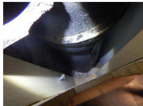
Kuva 258. Viemärin juuressa oli betonivalu. Koteloinnin pohjalla näkyi hieman rakennusjätettä.
