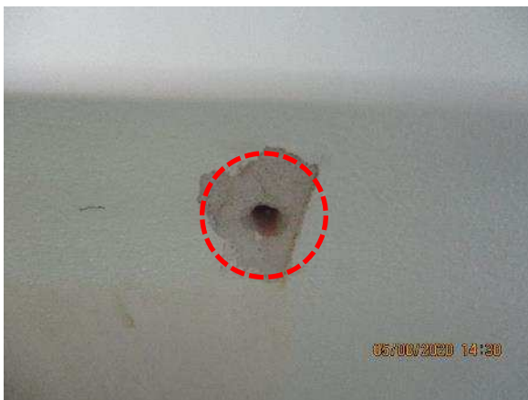
Kuva 203. MAK5: Vanhoissa patterikiinnityskohdissa havaittiin pistemäistä ilmavuotoa.
