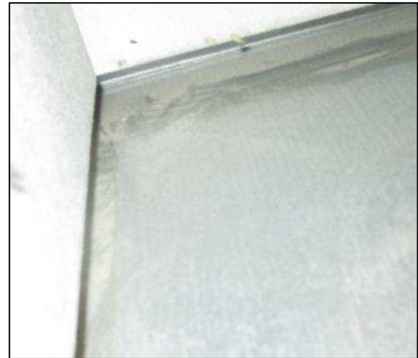
Kuva 491. TK05 palvelualue, luokka 30, tuloilman TKB-mallisen tasauslaatikon pohjalla nähtävissä puhdistusjäljet (puhdistus ei ole ulottunut reunoille asti)
