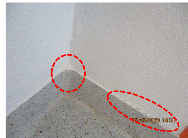
Kuva 202. MAK5: Ilmavuotokohtia havaittiin muovimaton ylösnostojen alueella, joka viittaa välipohjan ja ulkoseinäliitoksen epätiiveyteen.
