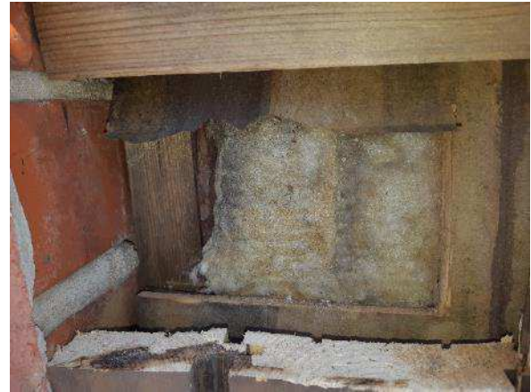
Kuva 131. Avauksessa US12 on havaittavissa ilma- vuotojen aiheuttamaa tummentumaa. Sisäpinnalta otetusta näytteestä havaittiin heikko viite mikrobivau- riosta.
