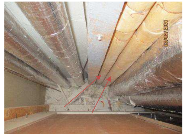
Kuva 278. Tarkastusluukun sisällä havaitut putkieristeet sisältävät asbestia.
