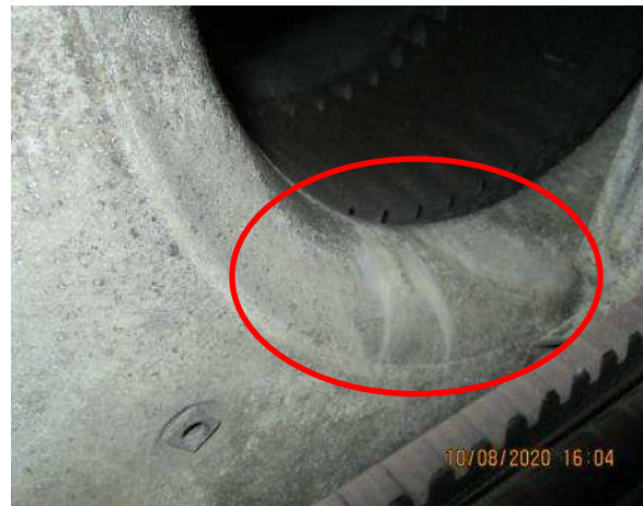
Kuva 441. TK05, puhaltimen imuaukon reunoilla pölyä/likaa (pyyhkäisyjäljet kuvassa)
