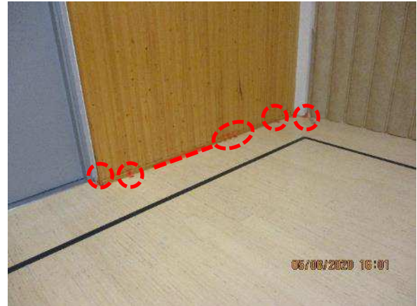
Kuva 243. MAK7: Ilmavuotoja havaittiin liikuntasalin puolella väliseinän ja välipohjan liitoskohdassa kuvaan merkityissä kohdissa.
