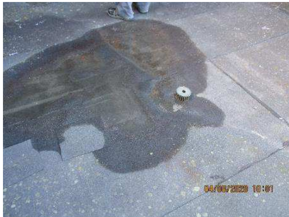
Kuva 336. Vesikatteen pinnalla on havaittavissa viitteitä sadevesien lammikoitumisesta.
