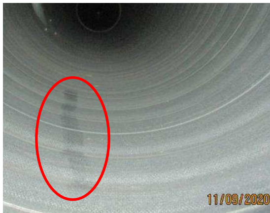
Kuva 473. TK05 palvelualue, kuraattorin huone, tuloilmakanavassa lievää pölykertymää. Pyyhkäisyjälki kuvassa.
