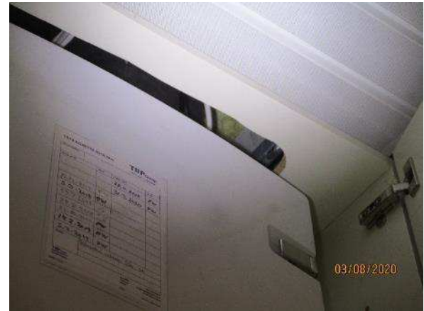
Kuva 284. Viereisten huoneiden IV-kone sijaitsee kaapiston sisällä IV-koneen läpiviennit ovat epätiivitä välipohjaan.
