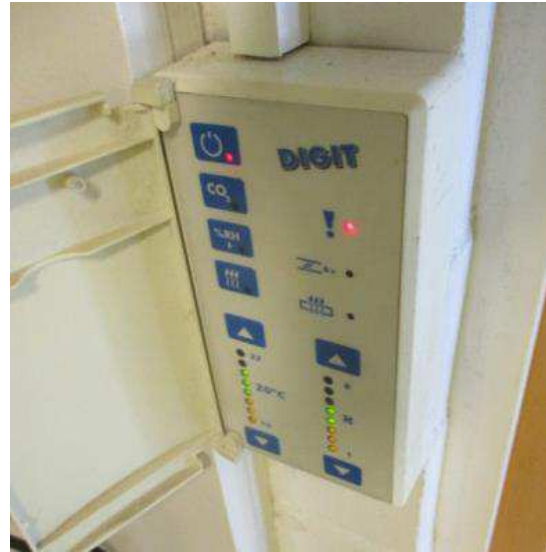
Kuva 444. TK07 ilmanvaihtokoneen ohjauspaneeli
