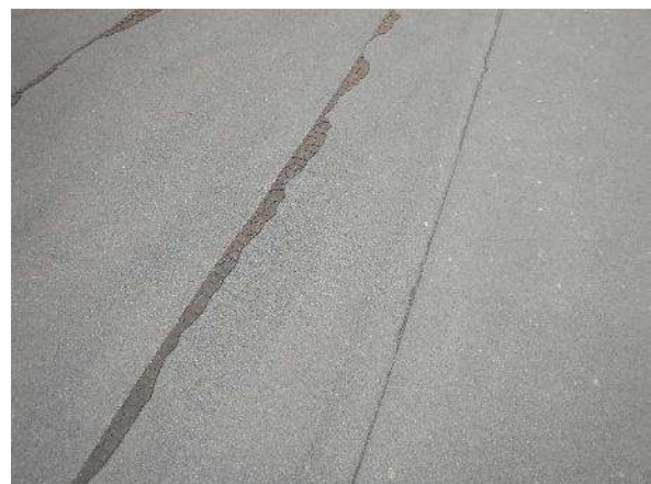
Kuva 321. Vesikatteen limityksien bitumisaumoissa on havaittavissa halkeamia.
