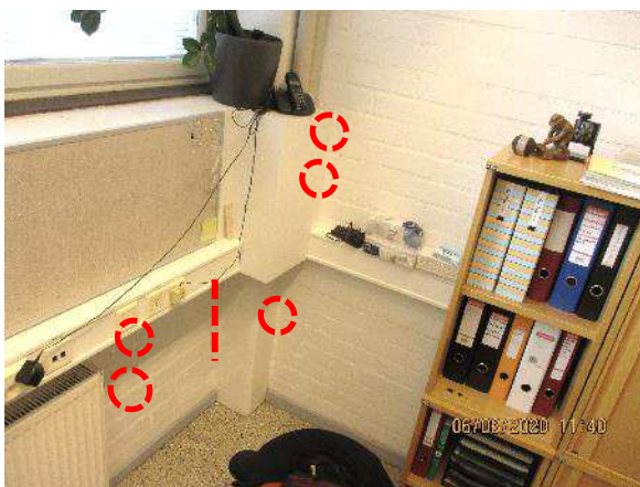
Kuva 215. Rehtorin huone 1087, MAK16: Havaitut ilmavuotokohdat merkittyinä kuvaan. Ilmavuotoa havaittiin tiilimuurauksen saumoista, pilarin ja ulkoseinän liitoksesta sekä lämpöputkikoteloinnista.
