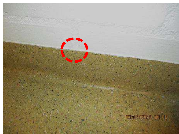
Kuva 62. MAK13: muovimaton ylösnoston ja tiilimuurauksen sauman liitoskohdasta havaittiin ilmavuotoa, joka viittaa alapohjan ja seinän liitoskohdan epätiiveyteen.
