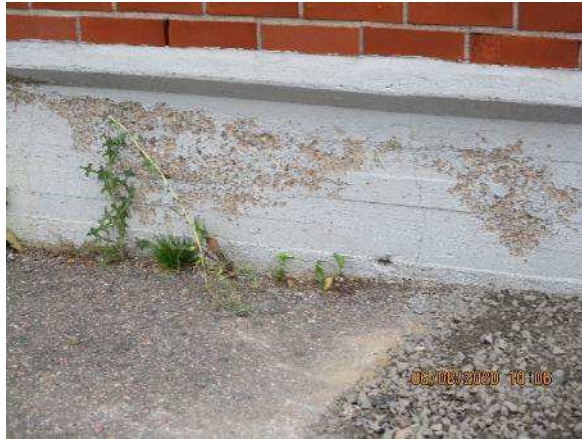
Kuva 90. Laajennusosan sokkelin maalipinta hilseilee alustastaan.
