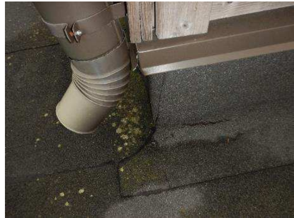
Kuva 343. Pajarakennuksen sadevesien ohjaus aiheuttaa kosteusrasitusta alkuperäiselle vesikatteelle.
