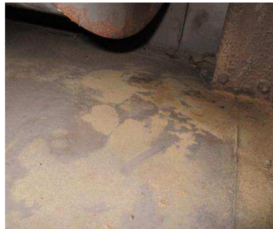
Kuva 435. TK04 puhallinkammiossa siitepölyä
