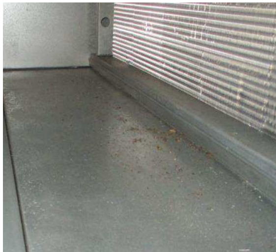
Kuva 415. TK02 lämmityspatterin ja puhaltimen väli- sessä kammiossa roskia
