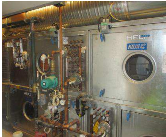
Kuva 449. Pajarakennuksen ilmanvaihtokone TK1
