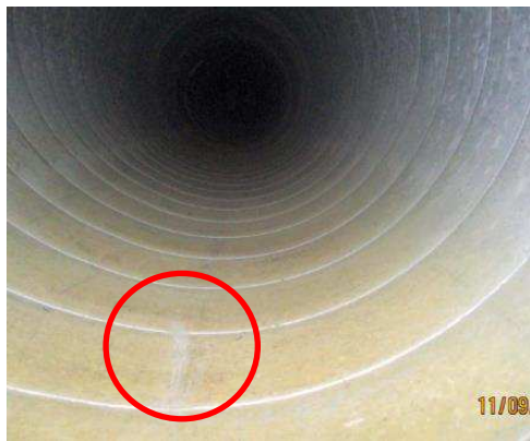
Kuva 461. TK03 palvelualue, tuloilmakanava opettajanhuoneen varastossa. Kanavan pohjalla pinnittyntä likaa ja siitepölyä. Pyyhkäisyjälki kuvassa
