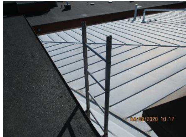
Kuva 337. Vesikatolla havittiin puutteita nousutikkaiden yläosissa, joista puuttuvat tukikaaret.
