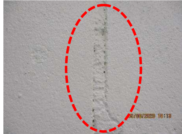
Kuva 74. MAK2: Ilmavuutokohtia havaittiin tiilimuurauksen saumakohdissa.
