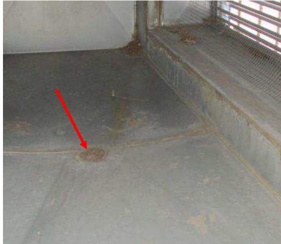
Kuva 409. TK01 (TK02) raitisilmakammion vedenpoistoaukko on roskien tukkima
