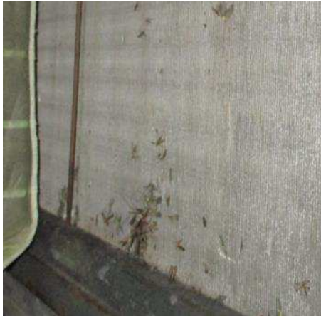
Kuva 432. TK04 lämmityspatterissa likaa ja hyönteisiä epätiivin suodatinasennuksen seurauksena
