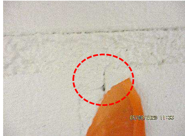
Kuva 212. MAK17: Tiilimuurauksen saumoissa havaittiin pistemäistä ilmavuotoa.
