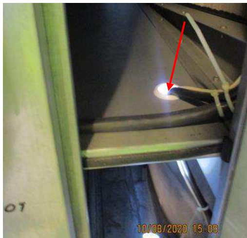
Kuva 427. TK03, epätiivis johtoläpimeno poisto- ja tuloilmapuolen välillä
