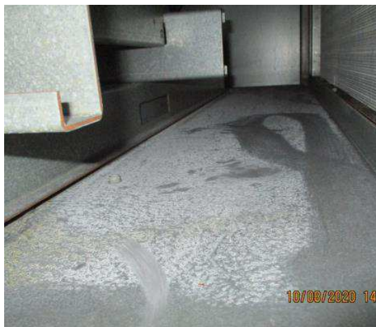
Kuva 423. TK03, tuloilmapuhallinkammiossa epäpuhtauksia
