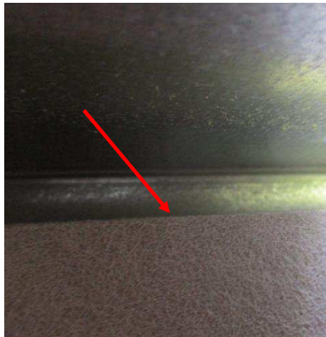
Kuva 492. TK05 palvelualue, tuloilman TKB-mallisten tasauslaatikoiden vaimenusmateriaalin reunoissa on suojaamatonta mineraalivillaa
