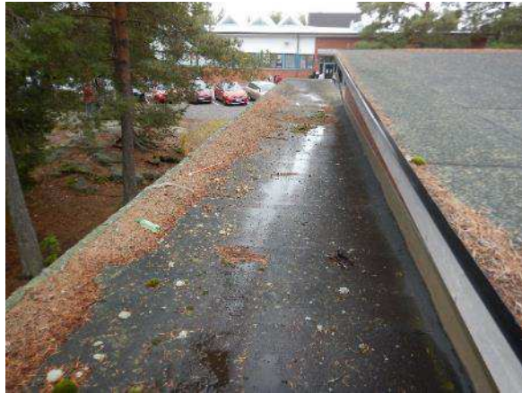
Kuva 352. Sadevesi lammikoituu pajarakennuksen alkuperäisen vesikatoksen alapuolella olevan katoksen pinnalle.
