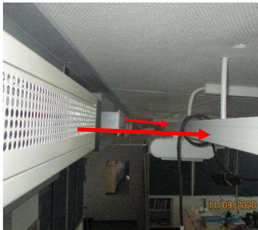
Kuva 501. Pajarakennus, luokkatila T28, sähkökisko sijaitsee epäideaalisti tuloilman virtausreitillä.
