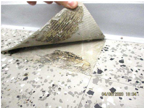
Kuva 19. Rakenneavaus AP3, käytävä 0019. Ohuen tasoitekerroksen alapinnalla on havaittavissa mustaa, asbestia sisältävää liimaa.
