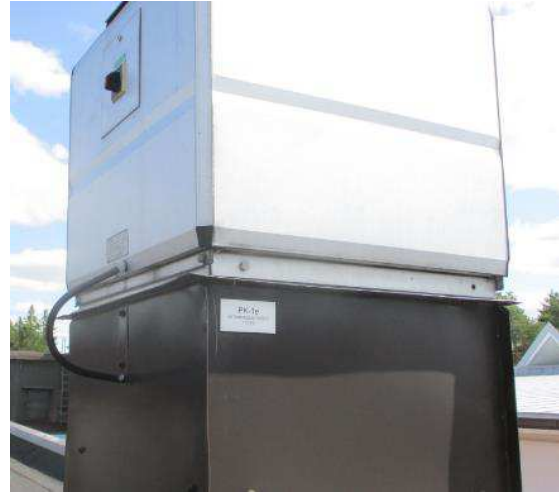
Kuva 418. Astianpesun poistoilman huippuimuri, jonka konetunnus on piirustuksia vastaavasti PK-1e
