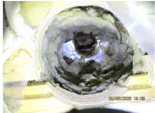
Kuva 175. Ponttilaudoitus on kahden tiiviin rakenne- kerroksen välissä, joka voi ajansaatossa aiheuttaa ra- kenteen vaurioitumisen.
