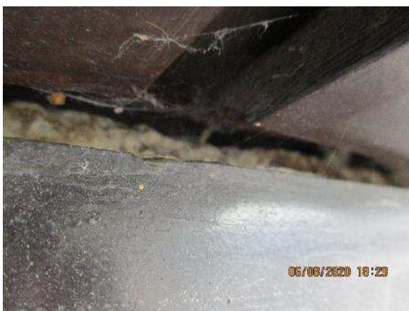
Kuva 134. Rakenneavaus US35 tehtiin sisäpuolelta. Avauskohdassa rakenne on epätiivis.
