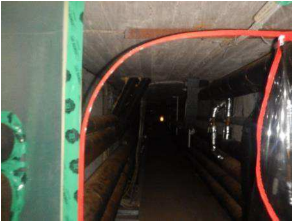
Kuva 290. Putkikanaalien alipaineistusta ja epäpuhtauksien leviämistä on pyritty hallitsemaan osastoinneilla
