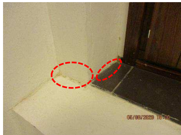
Kuva 210. MAK11: Myös koteloinnin yläosasta havaittiin ilmavuotoa.
