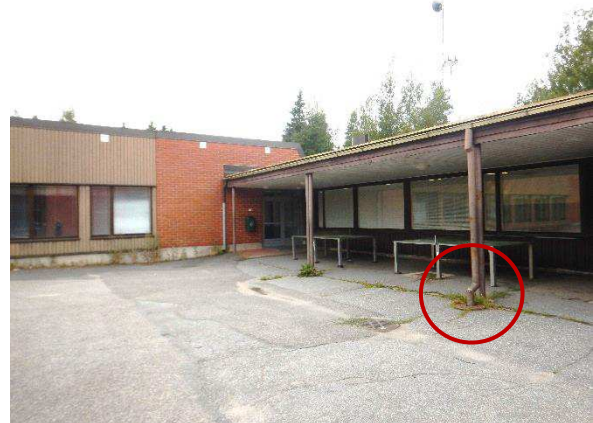
Kuva 382. Vain osa sadevesistä on johdettu suoraan sadevesikaivoihin.
