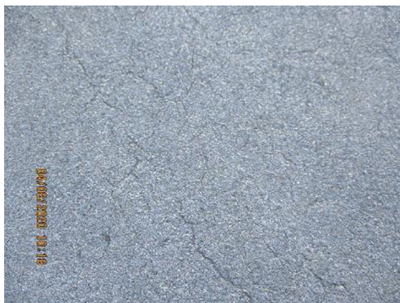
Kuva 320. Vesikatteen pinnalla on havaittavissa halkeamia.
