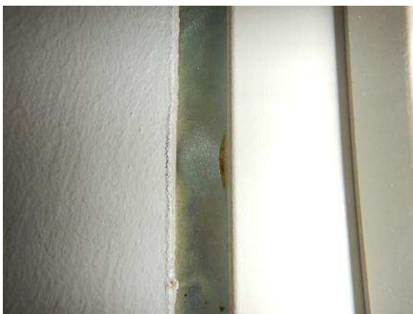
Kuva 144. Höyrynsulkumuovia ei oltu tiivistetty rakenteeseen.
