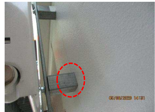
Kuva 204. MAK5: Ilmavuotokohtia havaittiin ulkoseinän patterikiinnikkeiden kohdalla.
