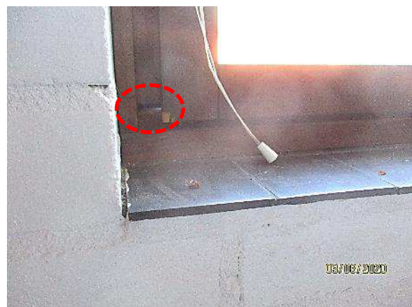
Kuva 216. Aistinvaraisesti havaittu epätiivelyskohta: Ikkunakarmin tiiveydessä on puutteita laajennusosalla.
