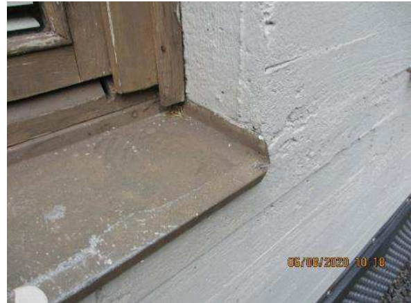
Kuva 97. Ikkunapellityksen ovat puutteellisia kiinnitystavaltaan sekä taiteosien korkeuksiltaan.
