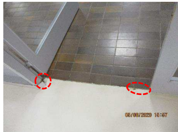
Kuva 241. MAK7: Ilmavuotoja havaittiin aulan ja ruokalan liitoskohdassa.
