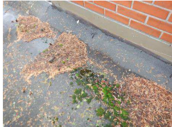
Kuva 353. Veden lammikoituminen voi aiheuttaa kosteusrasitusta ulkoseinärakenteille, mikäli ylösnosto ei ole tiivis.
