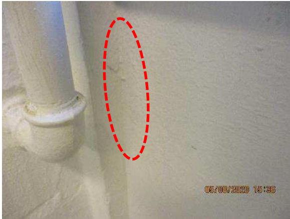
Kuva 199. MAK3: Patterisyvennyksen liitoskohdassa havaittiin ilmavuoto.
