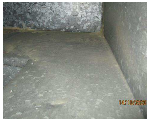
Kuva 470. TK04 palvelualue, liikuntasalin tuloilmakanava, pyyhintänäytteen PK2 ottopaikka. Kanavassa runsaasti siitepölyä.
