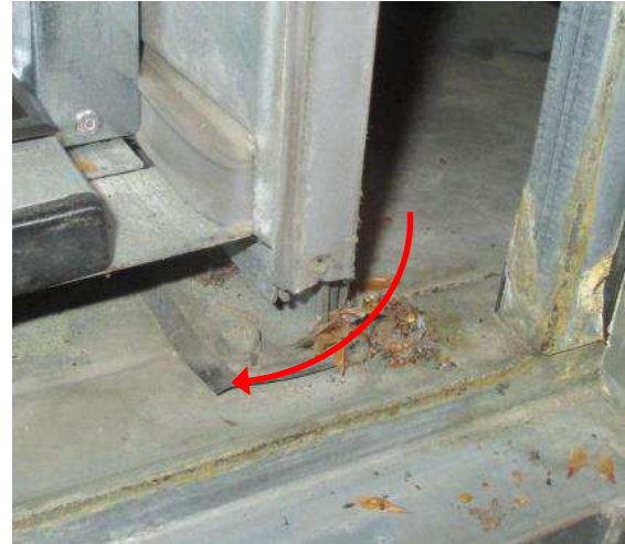
Kuva 410. TK01, suodatinkammion tiivistyksessä on puutteita asennuskehyyksen ylä- ja alareunassa.
