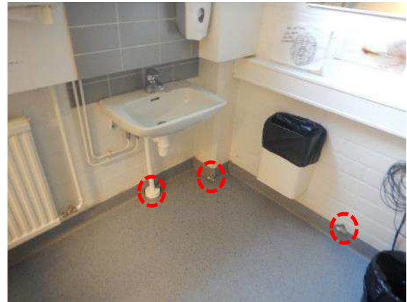
Kuva 305. MAK15: Ilmavuotoja havaittiin laittamaton ja väliseinän liittymäkohdassa, muovilistan takaa.
