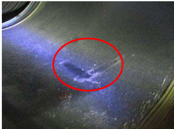
Kuva 479. Pajarakennus, tuloilmakanava iv-konehuoneessa, kanavassa lievää pölykertymä, pyyhkäisy jäljet kuvassa
