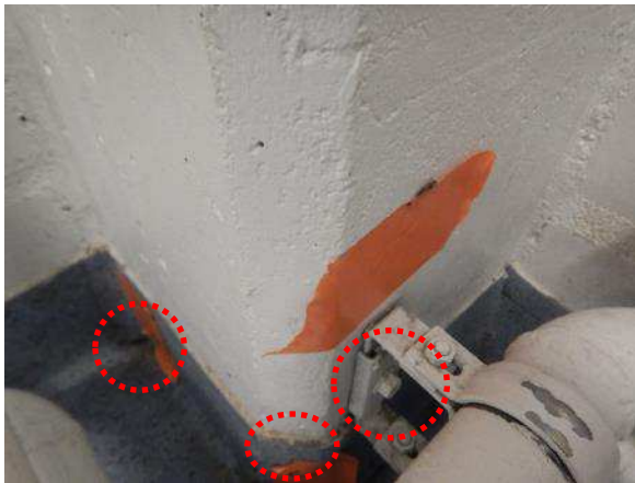
Kuva 59. MAK10. Ilmavuotoja havaittiin muovimaton ylösnostossa, jotka viittaavat alapohjan ja ulkoseinän liitoksen epätiiveyteen.
