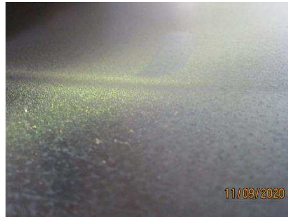
Kuva 487. TK05 palvelualue, luokka 19 (ATK), TLB-mallisen tuloilmapäätelaitteen pohjalla kellertävää pölyä (todennäköisesti siiteppölyä tai mineraalivillaa)
