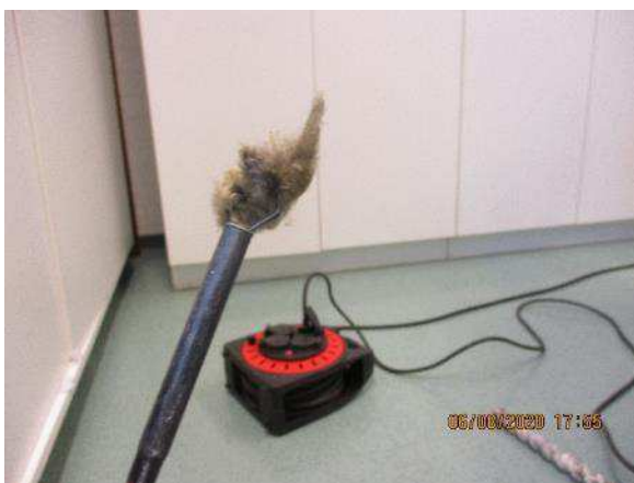
Kuva 185. Rakenneavauksesta otettiin mikrobinäyte mineraalivillaeristeestä. Mineraalivillassa on havaittavissa tummentumaa.
