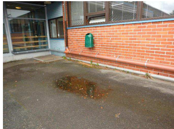
Kuva 384. Sisäpihan alueella on useita painaumuksia, joihin kertyy sadevettä.
