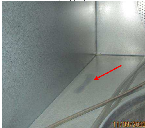
Kuva 483. IV-koneen TK01 palvelualue, ruokalan tuloilmapäätelaitteen tasauslaatikon sisällä lievää pölyyntymistä. Pyyhkäisyjälki kuvassa.
