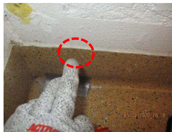
Kuva 61. MAK13: Epätiiveytskohta muovimaton ylösnoston alueella.
