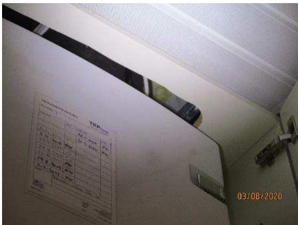
Kuva 375. Laajennusosan läpiviennit yläpohjatilaan ovat epätiivittä, jolloin ilmavirtauksen yläpohjatilan ja sisäilman välillä ovat mahdollisia.
