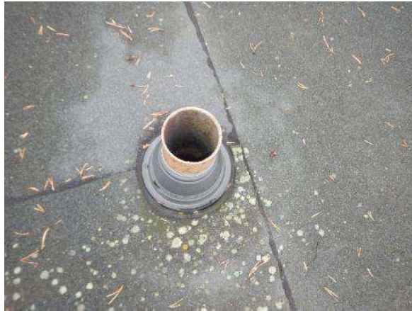
Kuva 346. Pajarakennuksen läpivienneistä puuttui paikoin sadehattuja.
