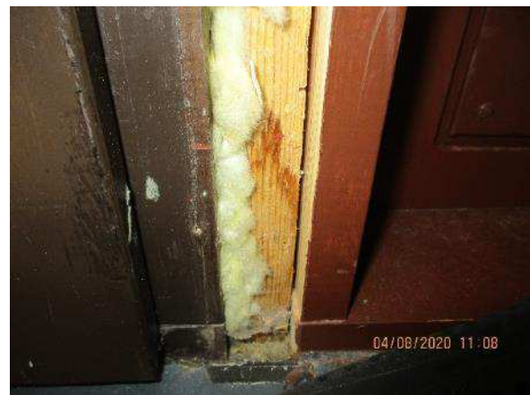
Kuva 179. Puurakenteessa havaittiin kosteuden aiheuttamia valumajälkiä.
