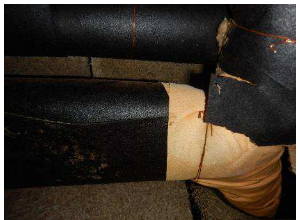
Kuva 299. Pajan putkikanaalin putkieristeiden pinnalla olevassa tervapaperissa havaittiin asbestia.
