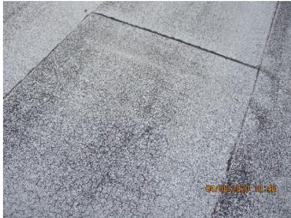
Kuva 316. Käytävän 1030 yläpuolella oleva vesikatteen pinta on halkeillut.
