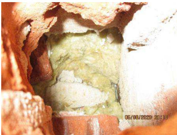
Kuva 114. Rakenteessa ei havaittu ilmarakoa. Julkisivutiilen sisäpinnalla on havaittavissa runsaasti laastipurseita. Rakenteessa on lisäksi havaittavissa betonipilarin takana olevaa korkkieristettä
