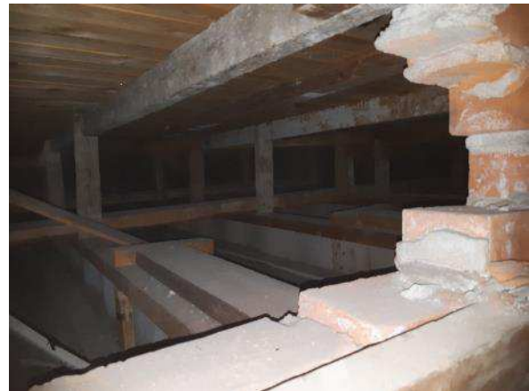
Kuva 313. Tiilimuuraus ei toimi siinä havaittujen aukotusten vuoksi palokatkona.
