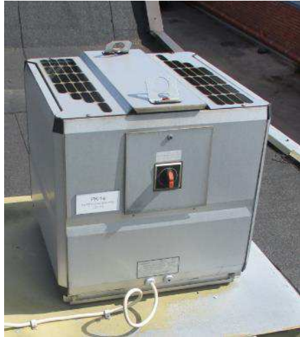
Kuva 417. Keittiön poistoilman huippuimuri, jonka konetunnus on piirustuksissa PK-1c, mutta koneessa on merkintä PK-1e
