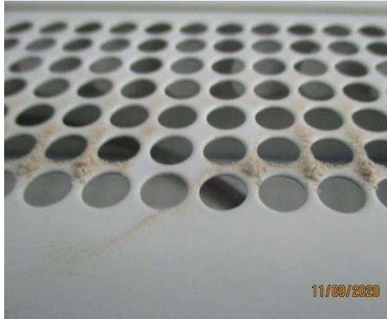
Kuva 496. Pajarakennus, puutyötilojen tuloilmapäätelaitteiden säleiköissä puupölyä
