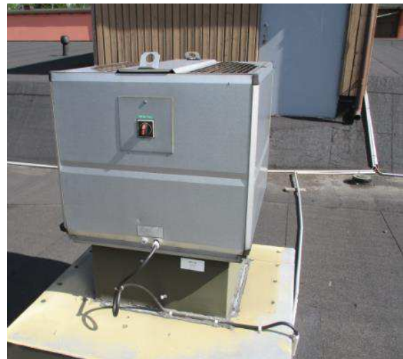
Kuva 416. Keittiön poistoilman huippuimuri PK-1b
