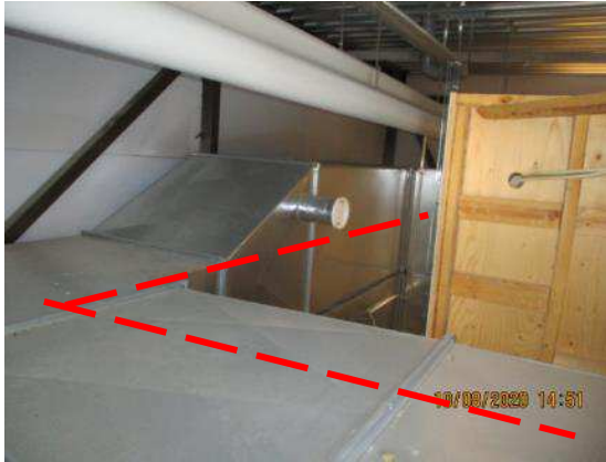
Kuva 465. TK03 palvelualue, poistoilmakanava iv-konehuoneessa: pitkä kanavaosuus, jossa ei puhdistusluukkua, kanavan puhdistettavuus kyseenalainen
