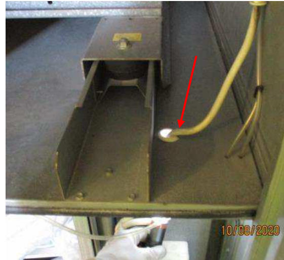
Kuva 426. TK03, epätiivis läpimeno poistopuhallinkammioista tuloilmapuolelle
