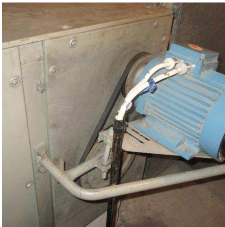
Kuva 434. TK04, puhallinmoottorin hihnäkäyttö sijaitsee koneen ulkopuolella vaarallisesti suojaamattomana
