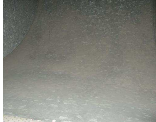
Kuva 466. TK04 palvelualue, tuloilmakanava iv-konehuoneessa, kanavassa lievää pölykertymää
