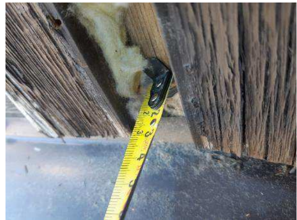
Kuva 133. Ikkunatilkkeenä on avausalueella käytetty mineraalivillaeristettä, josta otetusta näytteestä ei ha- vaittu mikrobivaurioviitettä.
