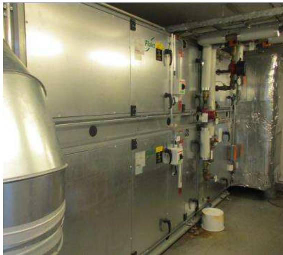
Kuva 407. TK01 kuvassa alempana (päällä keittiön tuloilmakone TK02)
