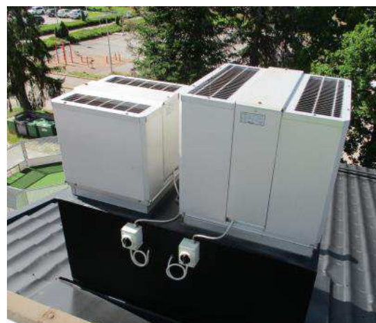
Kuva 437. TK04 palvelualueen poistoilmasta vastaavat huippumurit on uusittu, ilmeisesti vuonna 2012. Konekilvet puuttuu.
