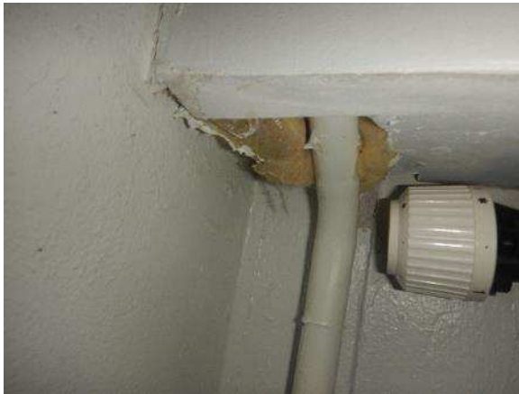
Kuva 253. Putkikoteloinneissa oli paikoin aukkoja, joista näkyi mineraalivillaeristeitä.
