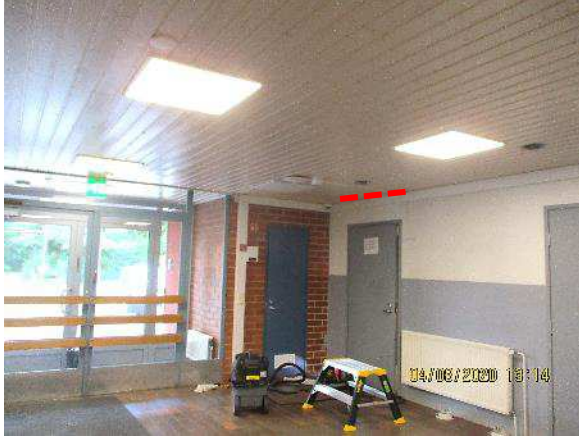
Kuva 380. Aula 1006, MAK 18: Ilmavuotoa havaittiin kuvaan merkityssä kohdassa.
