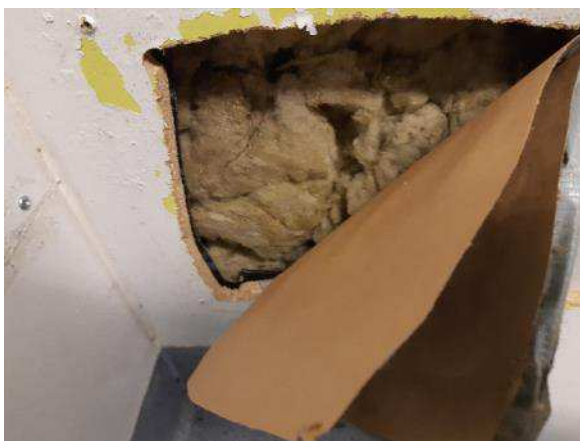
Kuva 162. Lastulevyn takana on kaksi kerrosta muovipinnoitteista pahvia tai pahvi on limitetty nurkassa.
