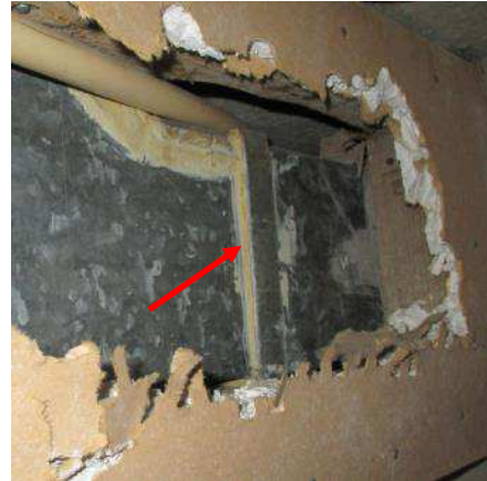
Kuva 472. TK04 palvelualue, salin näyttämön parvitila, alkuperäinen poistoilman suorakaidekanava, jonka tiivisteessä mahdollisesti asbestia.
