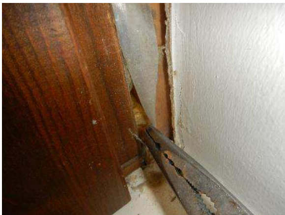
Kuva 138. Höyrynsulkumuovin asennustapa on epätiivis
