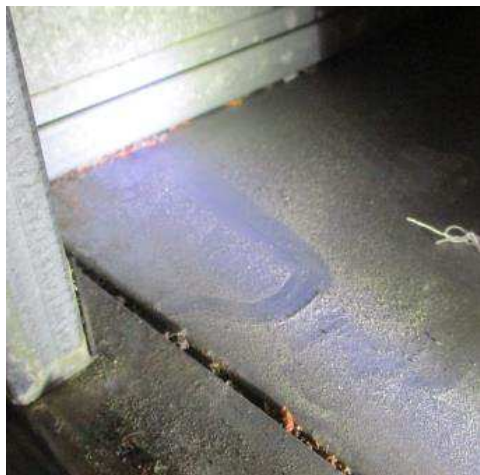
Kuva 411. TK01 suodatinkammio on likaantunut suodattimen ohivuotojen seurauksena.
