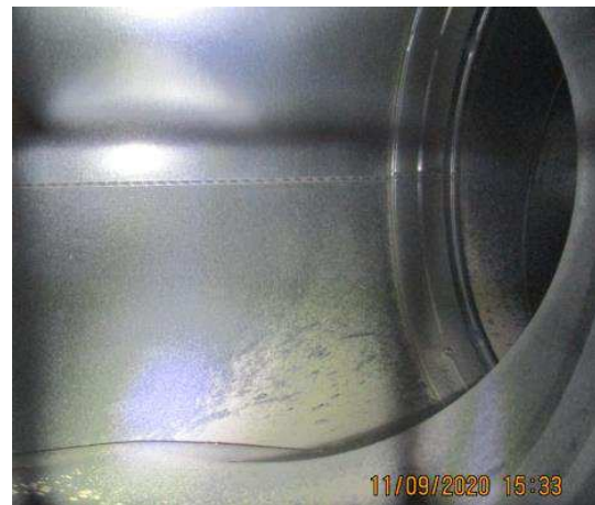
Kuva 482. Pajarakennus, puutyöluokan poistoilmakanavassa puupölykertymä.
