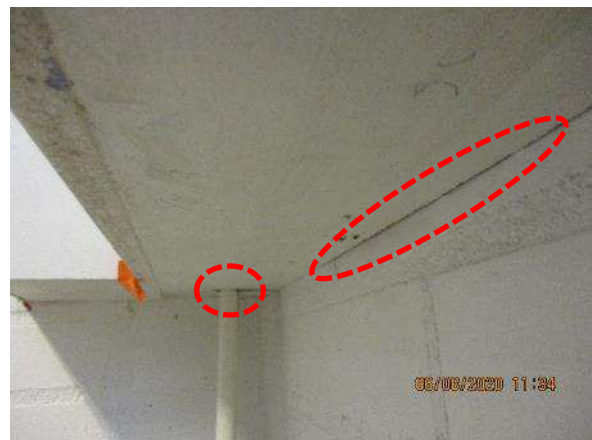
Kuva 214. MAK17: Lämpöputkikoteloinnissa havaittiin vähäistä ilmavuotoa ulkoseinäliitoksen alueella.
