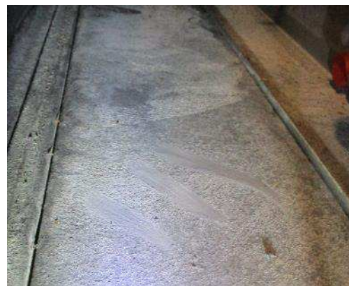
Kuva 422. TK03, LTO-kennon ja lämmityspatterin välillä ilmeisesti kennon sulamisvedestä peräisin olevia kosteusjälkiä/korroosiotuotteita
