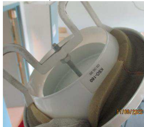
Kuva 484. Vuonna 1999 asennettu poistoilmaventtiili (Luokkatila 9). Venttiili puhdas.
