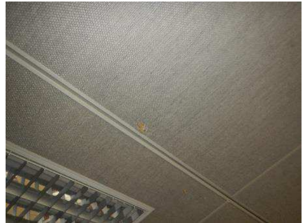
Kuva 400. Mineraalivillaeristeisissä akustolevyissä havaittiin paikoin reikiä.
