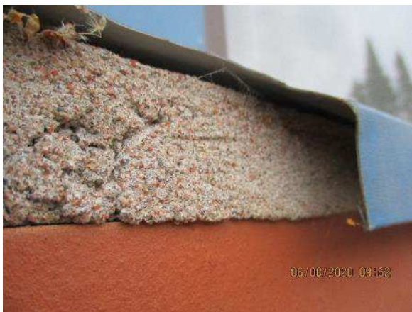
Kuva 98. Ikkunoiden kiinnitystapa ei mahdollista ulkoseinärakenteen tuulettumista pellityksen alta.
