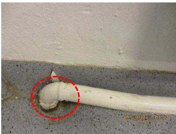
Kuva 197. MAK3:Lämmitysputken läpiviennissä havaittiin pistemäinen epätiiveyskohta. Lisäksi patterikiinnikkeissä havaittiin pistemäistä ilmavuotoa.
