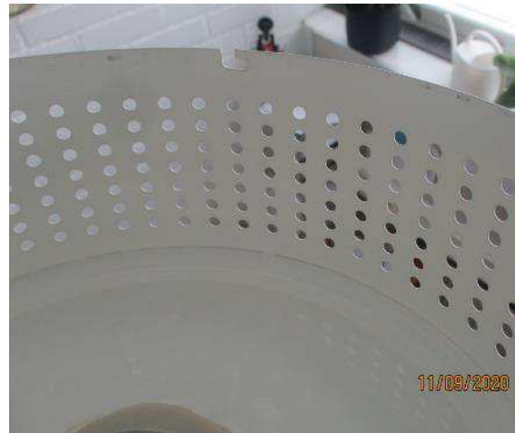
Kuva 493. IV-koneen TK07 palvelualue, kanslian tuloilmapäätelaite on puhdas
