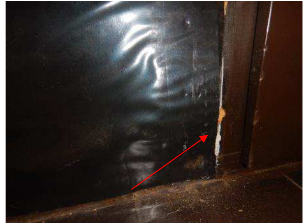
Kuva 168. Höyrnsulkumuovia ei oltu tiivistetty rakenteeseen.
