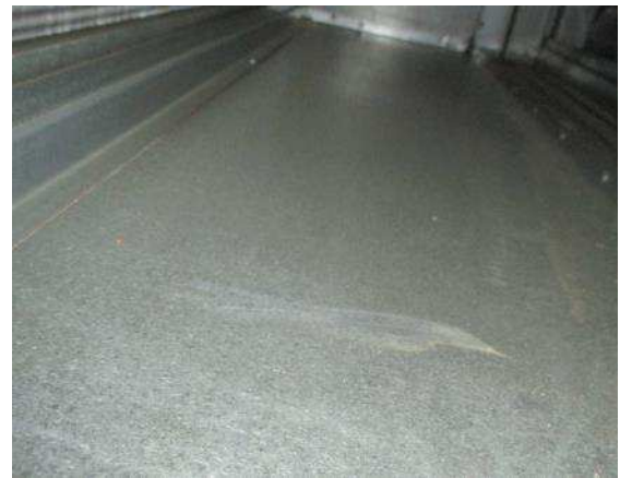
Kuva 452. LTO-patterin ja lämmityspatterin välillä siitepölyä
