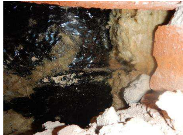
Kuva 116. Ulkokuoren pinnalla on paksu bitumisively, jonka PAH-yhdisteiden pitoisuus ylittää vaarallisen jätteen ohjearvon.
