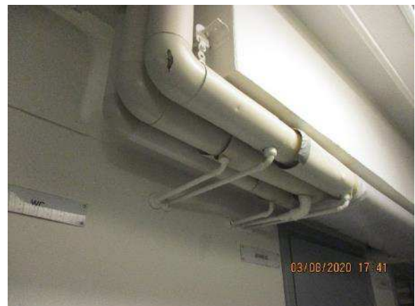
Kuva 402. Osa putkieristeiden pinnoista oli rikkoutunut tai pinnoitteiden saumojen tiivistys on puutteellinen. Myös osa putkikotelointien läpivienneistä ovat puutteellisia (kuva Väliseinät-kappaleessa).
