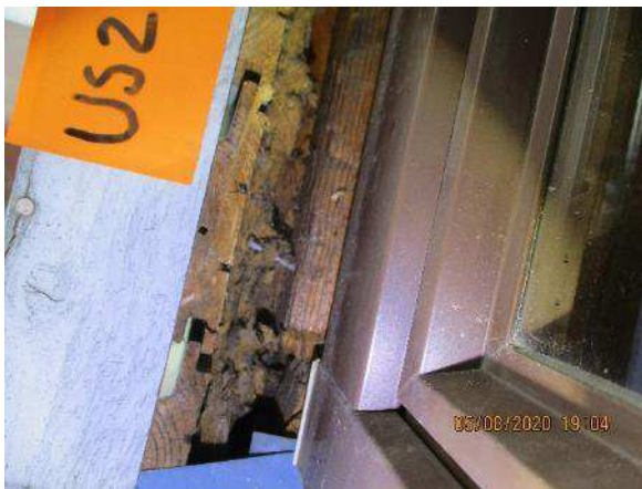
Kuva 159. US21: Rakenteessa ei ole havaittavissa tuuletusrakoa, vaan puuverhous on kiinni tuulensuojalevyssä.
