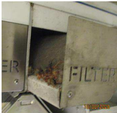
Kuva 445. Tuloilman karkeasuodattimessa runsaasti hyönteisiä
