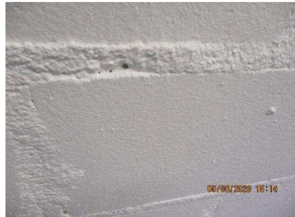
Kuva 69. Maanvastaisen ulkoseinän sisäkuorimuurausta. Muuratuissa saumoissa on havaittavissa epätiivelyskohtia.
