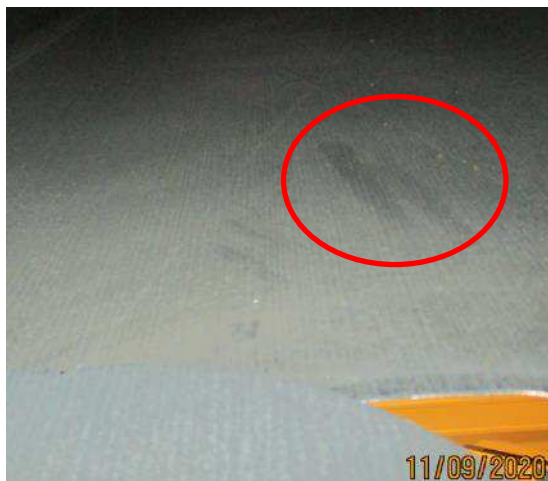
Kuva 475. TK05 palvelualue, opon huone, tuloilmakanavassa lievää pölykertymää. Pyyhkäisyjäljet kuvassa.
