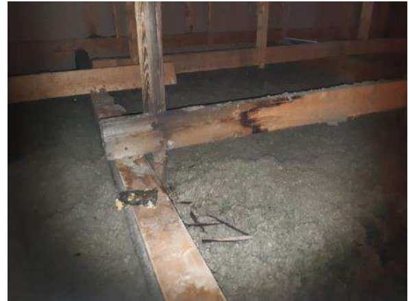
Kuva 372. Yläpohjatilan kosteusvaurioituneita puurakenteita.
