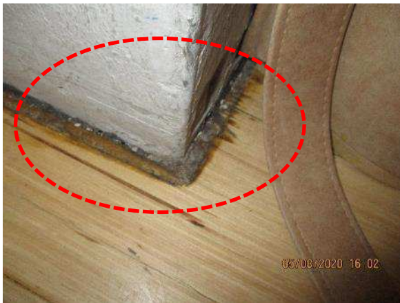
Kuva 244. MAK7: Ilmavuotoja havaittiin Betonirakenteisen pilarin ja välipohjan liittymässä.
