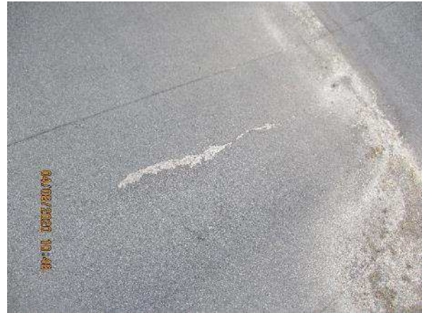
Kuva 311. Huopakatteen pintasirote on paikoin irtoillut.
