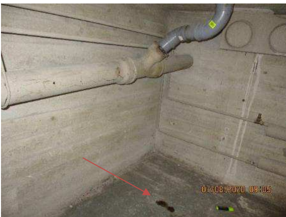
Kuva 298. Pajan putkikanaalin sisääntulon viemärisissä havaittiin vuoto.
