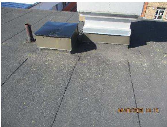
Kuva 324. Vesikatolla on läpivientejä, joista puuttuvat harjaitteet, jotka ohjaisivat sadevedet pois läpivientien alueelta.
