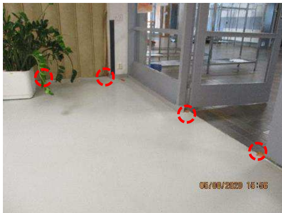
Kuva 240. Kiinteistönhoitajan huoneen ja yläpuolella olevien ruokalan ja liikuntasalin välisen välipohjan tiiveystarkastelu, MAK7: Merkkiainekokeessa ruokalan alueella havaitut ilmavuotokohdat merkittynä kuvaan.
