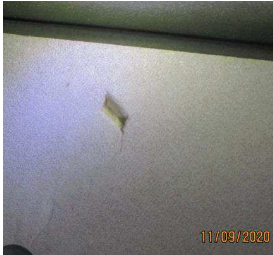
Kuva 490. TK05 palvelualue, luokka 30, tuloilman TKB-mallisen tasauslaatikon vaimenusmateriaalin suojaus on rikkoutunut
