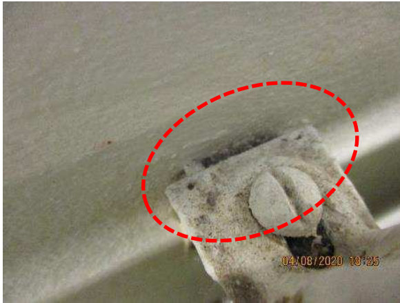
Kuva 193. MAK4: Pistemäistä ilmavuotoa havaittiin patterikiinnikkeessä.
