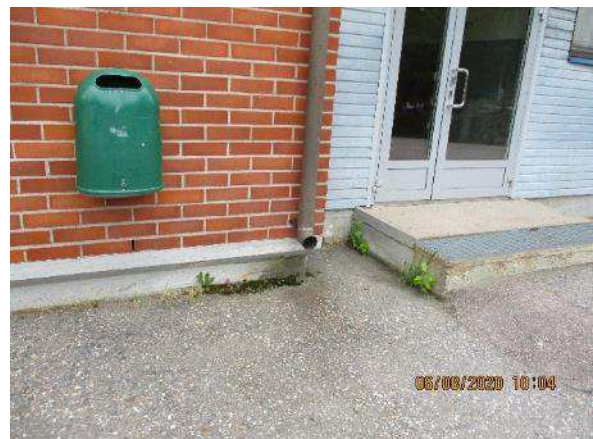
Kuva 89. Laajennusosan sadevedet ovat aikaisemmin ohjautuneet syöksytorstista sokkelinvierustoille. Tutkimusten aikana sadevesien ohjausjärjestelmään tehtiin korjaustoimenpiteitä. Sokkelin vierustalle ohjautuneet sadevedet ovat lisänneet ajan saatossa sokkelirakenteen kosteusrasitusta.
