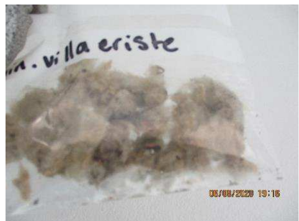
Kuva 135. Rakenteesta otettiin mikrobimateriaalinäyte laboratorioanalyysia varten, analyysissa havaittiin viite mikrobivauriosta.
