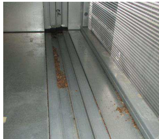
Kuva 412. TK01 lämmityspatterin ja puhaltimen välisessä kammiossa roskaa
