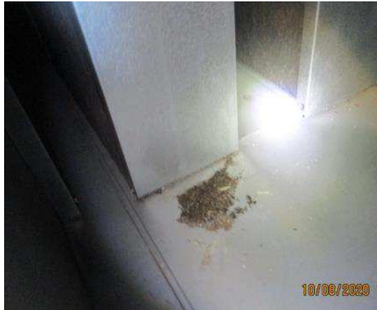
Kuva 442. TK05, äänenvaimentimen jälkeisessä kammiossa roskakertymä
