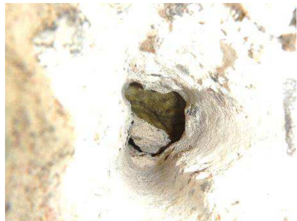
Kuva 183. Rakenneavauksesta oli aistittavissa mikrobiperäinen haju ja mineraalivillaeristeestä otetusta näytteestä havaittiin viite mikrobivauriosta.
