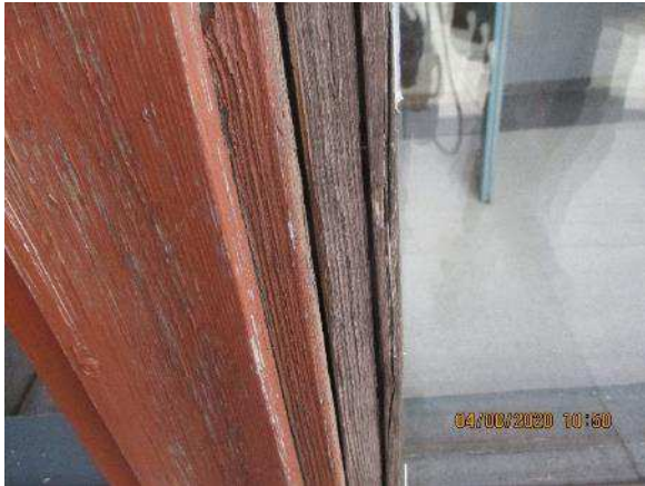
Kuva 96. Ikkunoiden puuosat ovat paikoin heikkokuntoisia.
