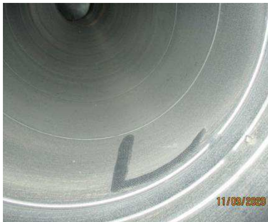
Kuva 481. Pajarakennus, luokkatila T28, poistoilmakanavassa normaalia pölykertymä, pyyhkäisy jälki kuvassa
