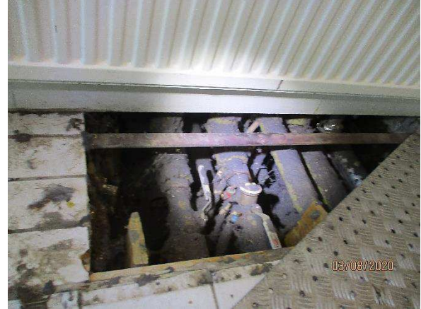
Kuva 301. Putkikanaali-laajennusosa: Putkikanaalin luukku on epätiivis.
