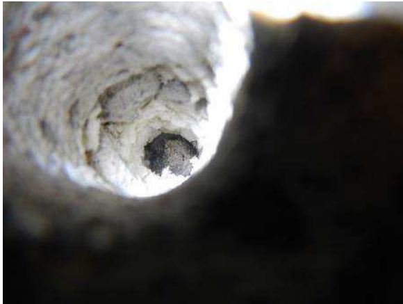
Kuva 25. EPS-eristeen alapuolella havaittiin bitumisively.
