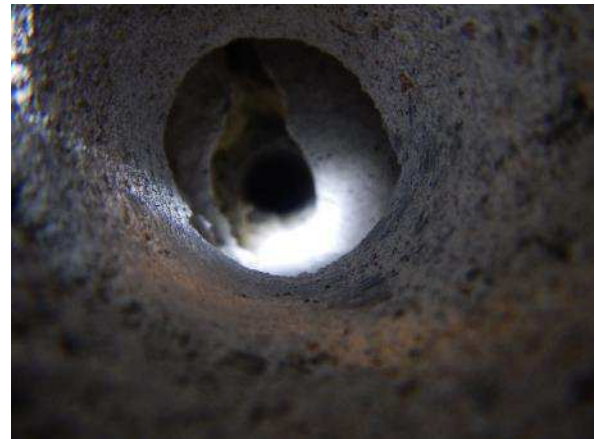
Kuva 188. Rakenneavauksesta US27 havaittiin mikro-biperäinen haju.
