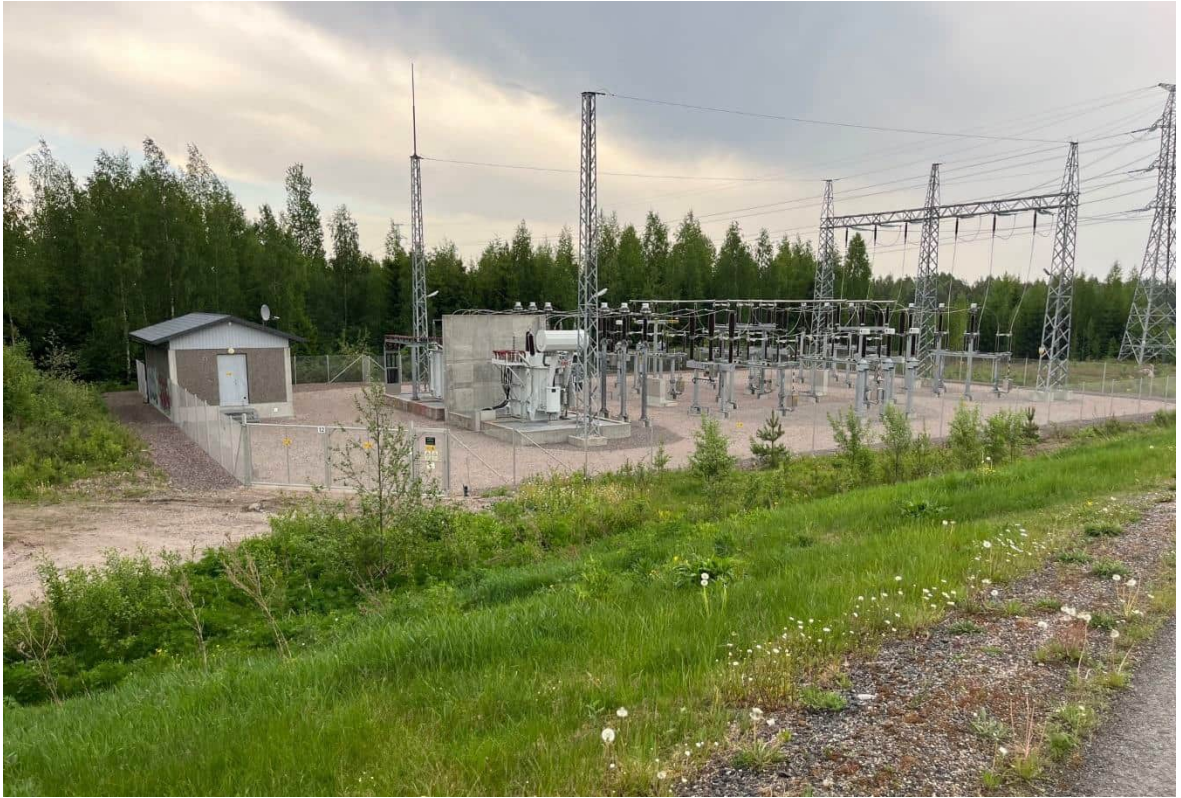
Kuva 7.4 Esimerkki sähköasemasta. Vasemmassa reunassa näkyy kytkinrakennus ja sen oikealla puolella betonisella alustalla on muuntaja. Muuntajan oikealla puolella ovat aseman katkaisijat ja erottimet. Tämä sähköasema sijaitsee Riihimäen Herajoella. Kuva: Sitowise Oy.
